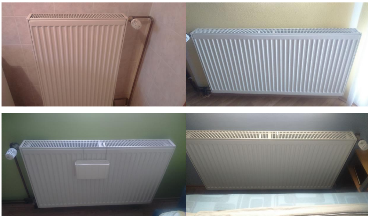
Slika 4.2 Instalirani pločasti radijatori
