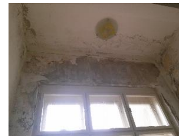
A. Otpadanje žbuke s vanjskog zida iznad prozora
