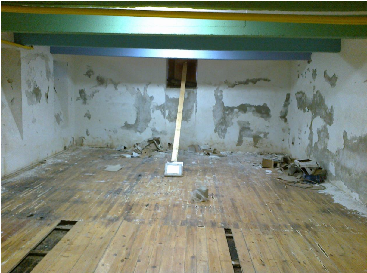
Slika 5.6 Drveni podovi u podrumu (parket u dvorani) su nabubрили i odvojili se od podloge
