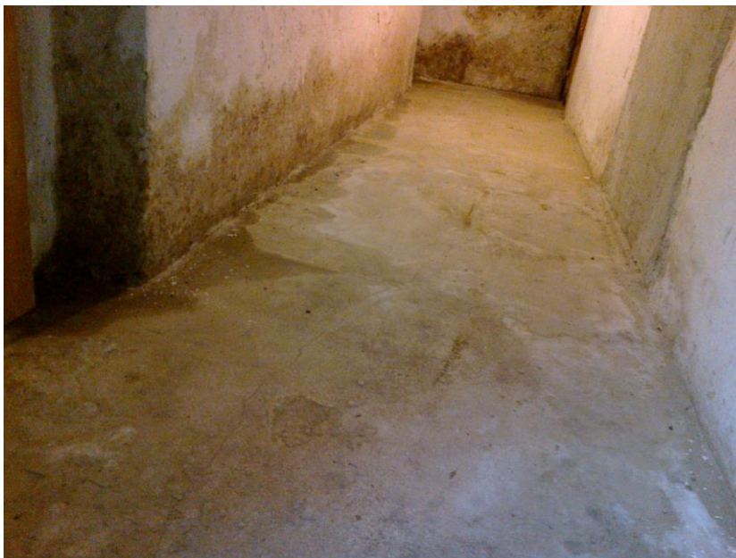
Slika 2.1 Vlažni zid u podrumu predmetne zgrade
