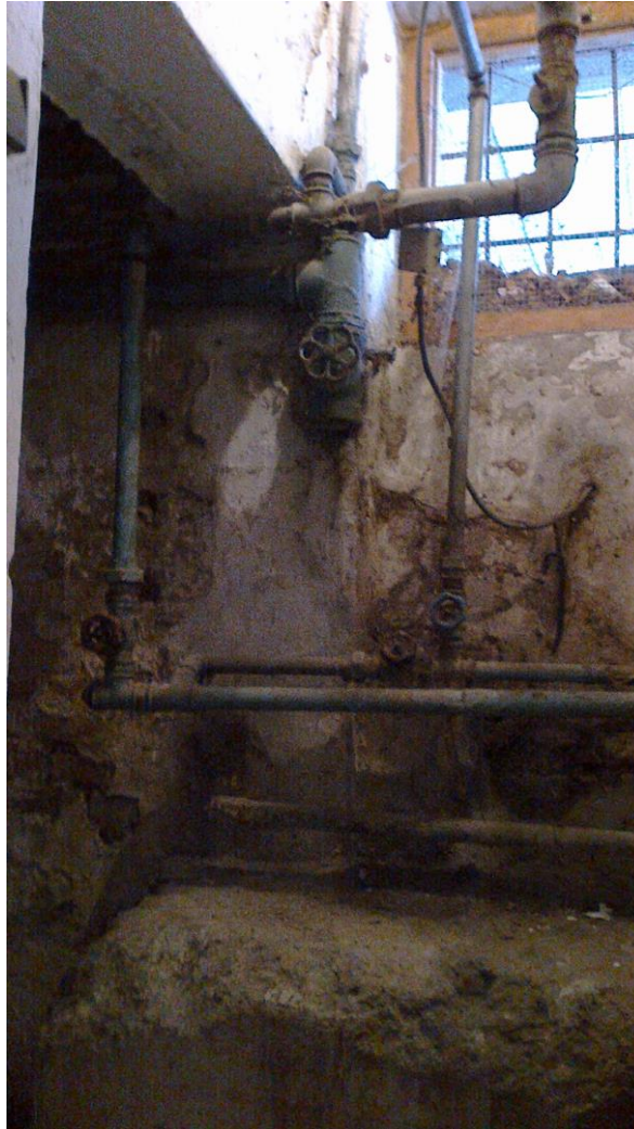
Slika 2.4 Dotrajale vodovodne instalacije predmetne zgrade
