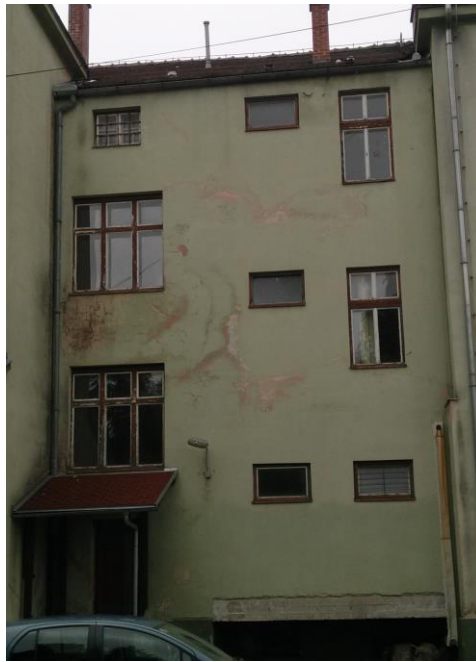
Slika 2.5 Utjecaj vlage i atmosferilija na fasadu predmetne zgrade
