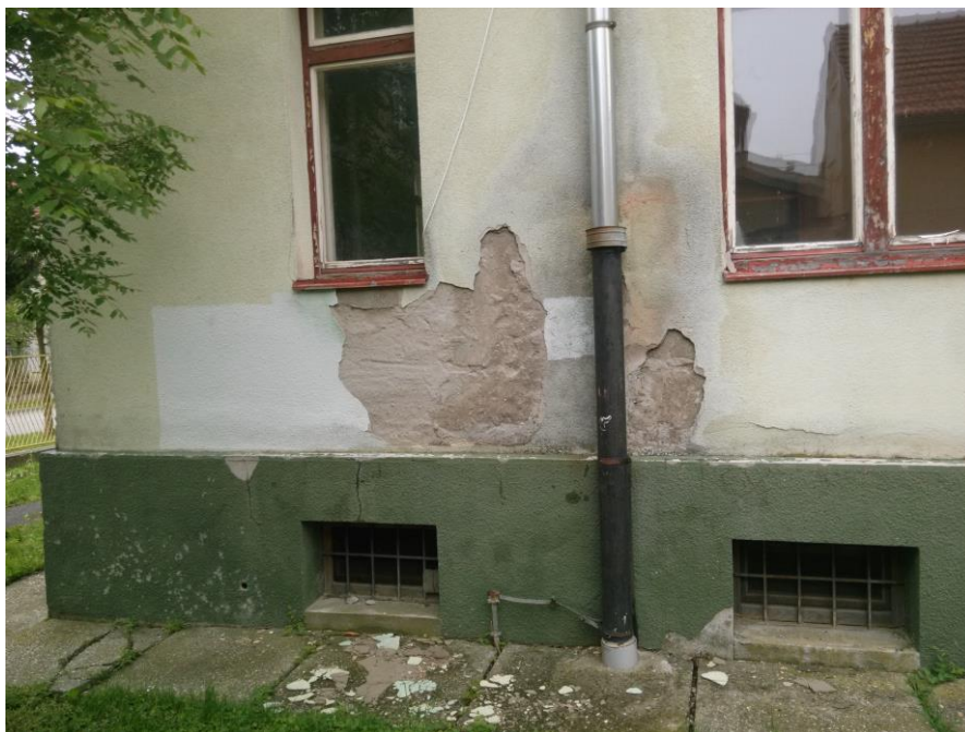
Slika 2.2 Osipanje fasade predmetne zgrade
