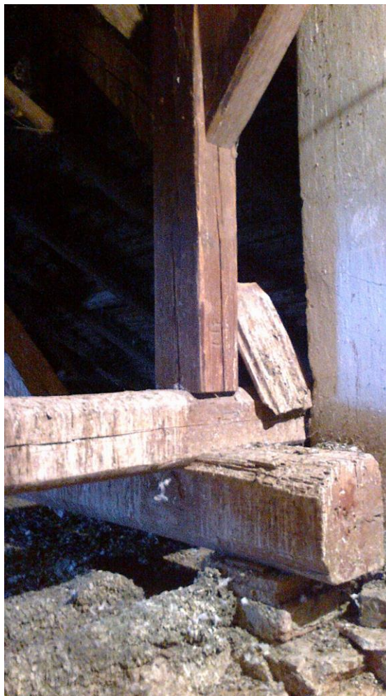
Slika 2.3 Dotrajala krovna konstrukcija predmetne zgrade
