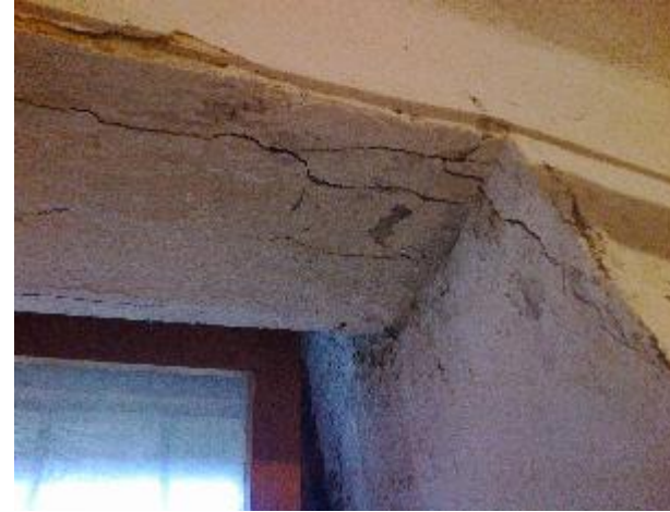
D. Sitne pukotine na nadvoju iznad prozora
