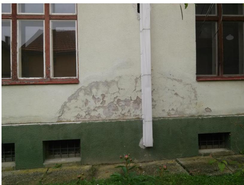
Slika 5.9 Oštećenja na ovojnici zgrade uslijed utjecaja vlage ostalih atmosferilija
