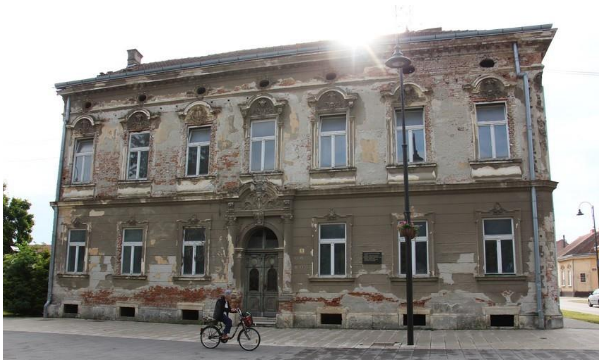
Slika 3.3 Kapilarna vlaga u zidovima povijesne građevine (kuća „Dolenec“ u Koprivnici)
