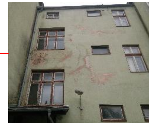
Razorno djelovanje vlage na vanjsku ovojnicu zgrade
