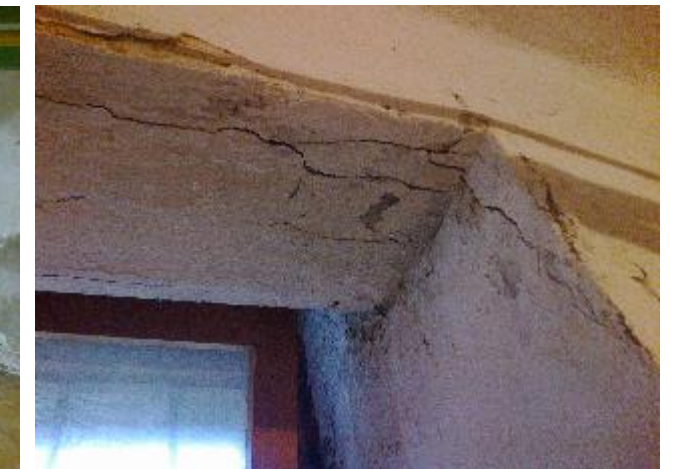
D. Sitne pukotine na nadvoju iznad prozora
