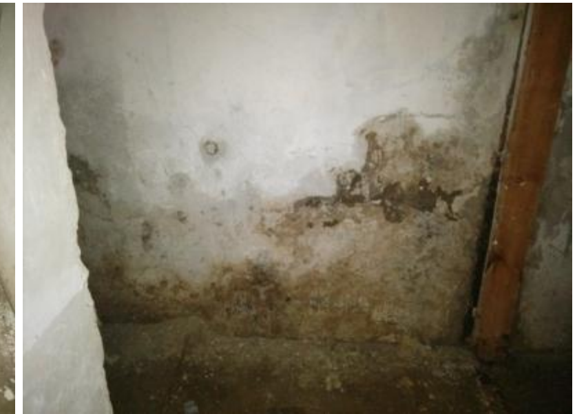
B. Kapilarna vlaga u zidovima
