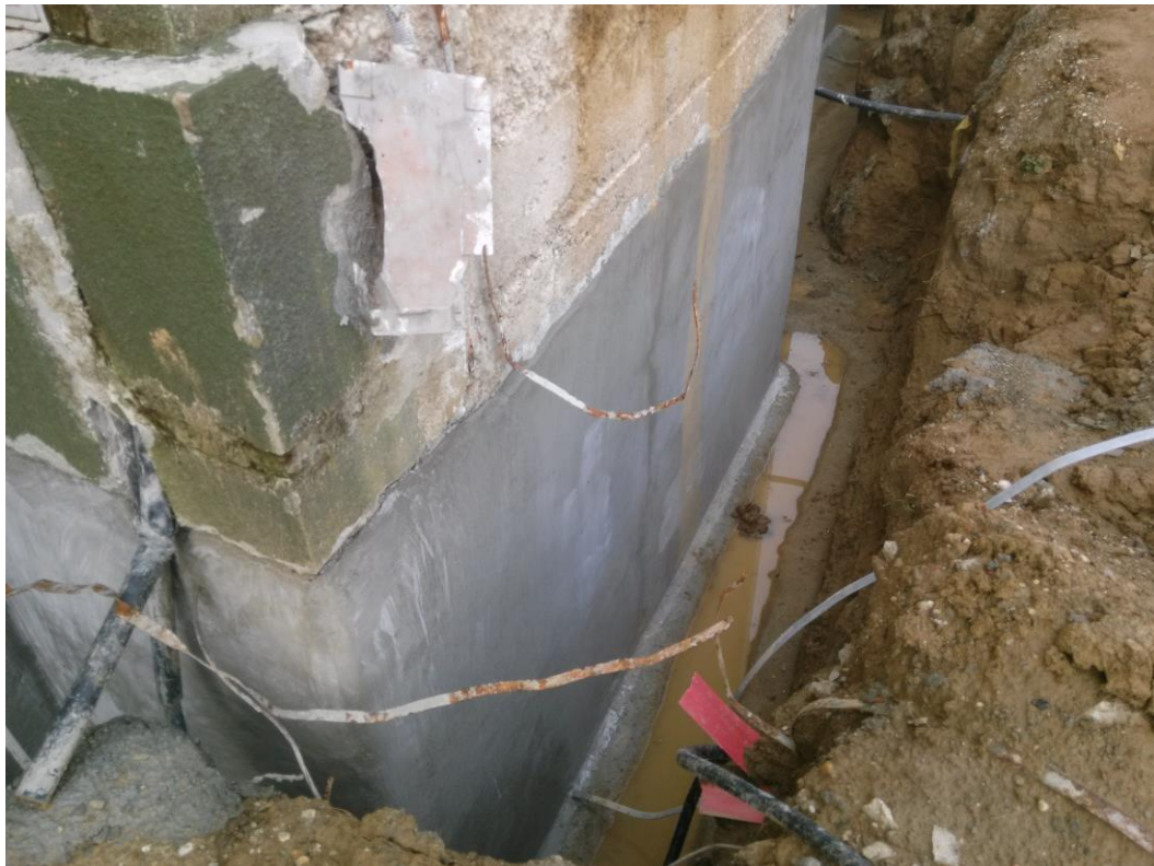
Slika 5.16 Otkopavanje oko zidova i izrada vertikalne hidroizolacije zidova sa dvokomponentnim elastičnim vodonepropusnim premazom, u tri sloja
