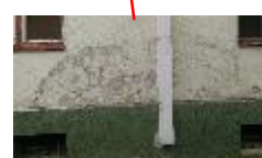
Prisutnost kapilarne vlage u vanjskom zidu prizemlja
