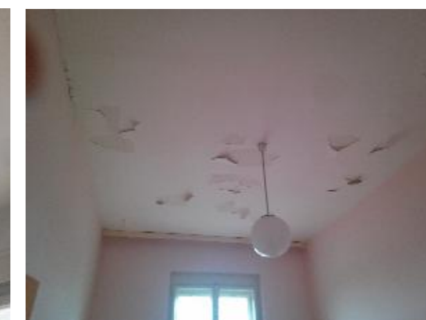
D. Otpadanje žbuke sa stropova
