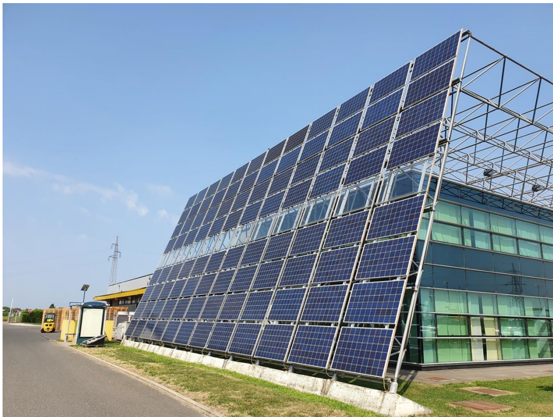
Slika 12. Prikaz izvedbe ožičenja i povezivanja stringova po objektu. Izvor: Autorova originalna fotografija, lokacija: Solvis d.o.o., Varaždin
