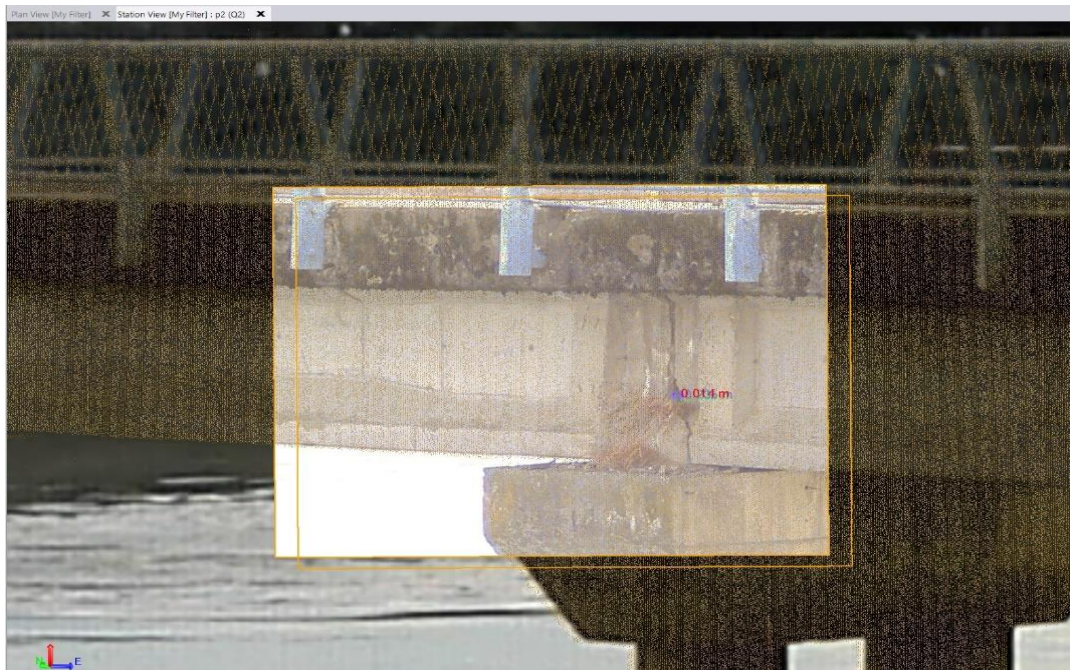
Slika 22. Mjerenje oštećenja mosta sa stajališta 2
