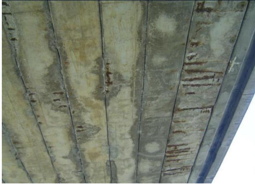
Slika 5. Primjer pogleda na rasponsku konstrukciju - vidljivi tragovi korozije [20]
