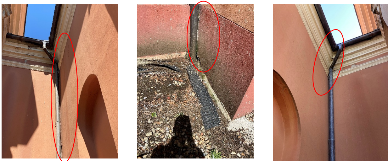
Slika 8.1. Vanjska oštećenja na spoju južne bočne kapele
