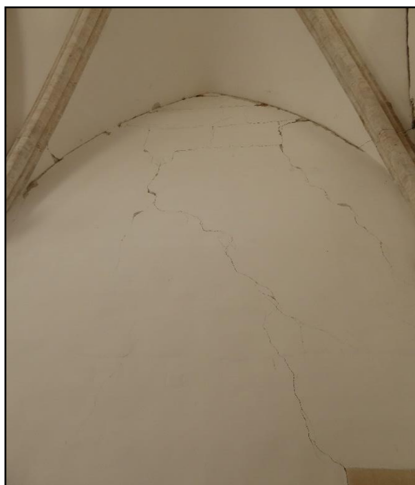
Slika 116. Pukotine na zidu crkve
