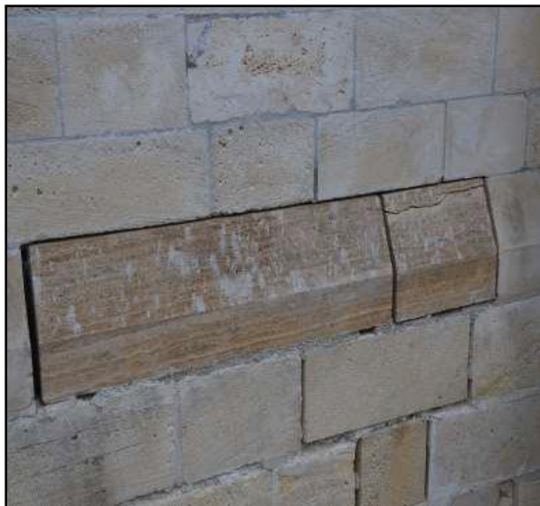
Slika 53. Detalj oštećenja kamena plivita (1)
