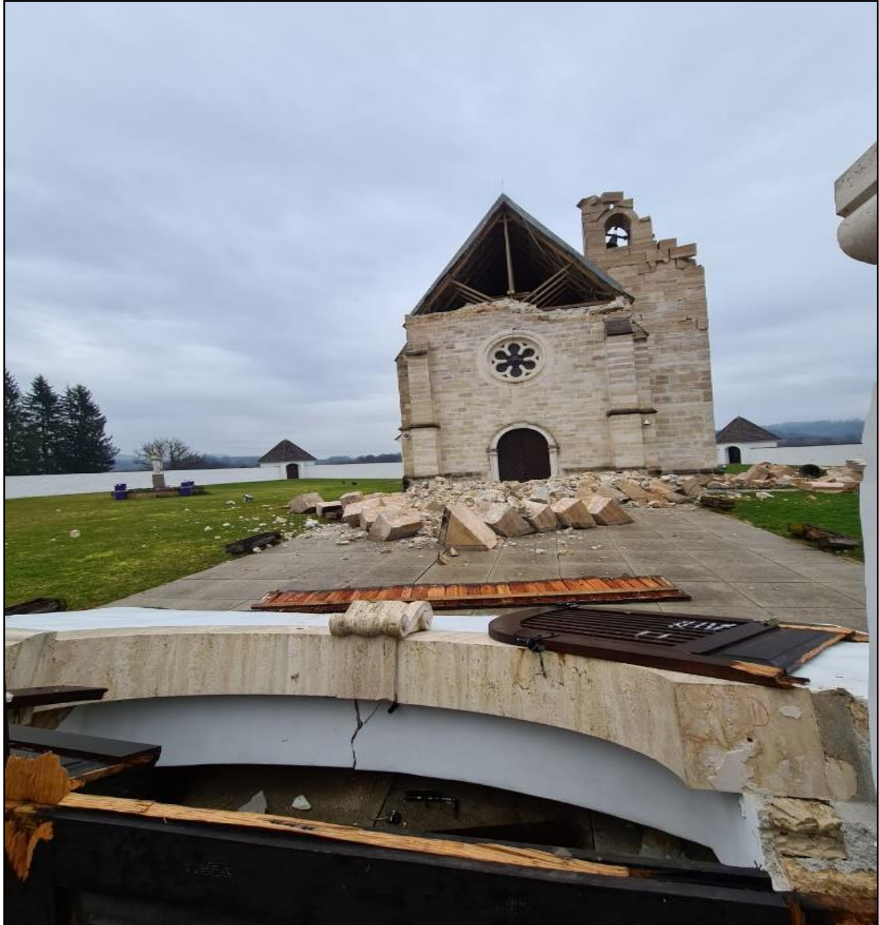
Slika 108. Razrušena crkva nakon potresa
