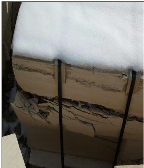
Slika 49. Detalj oštećenja lokalnog kamena (1)
