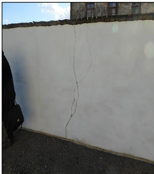
Slika 114. Pukotine na južnom zidu cinktora
