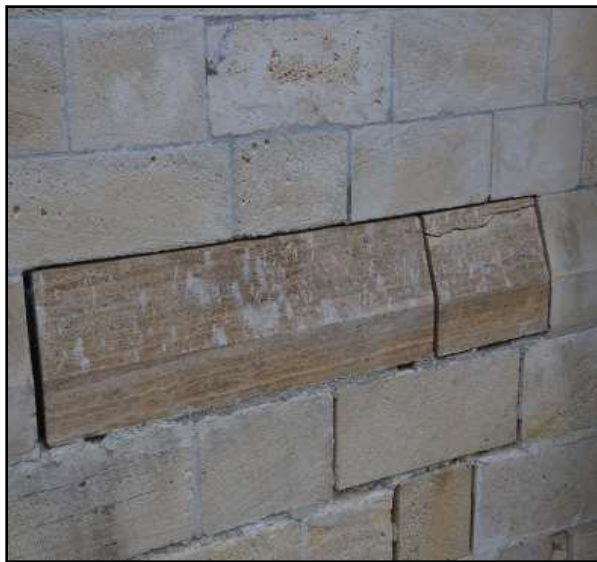
Slika 53. Detalj oštećenja kamena plivita (1)
