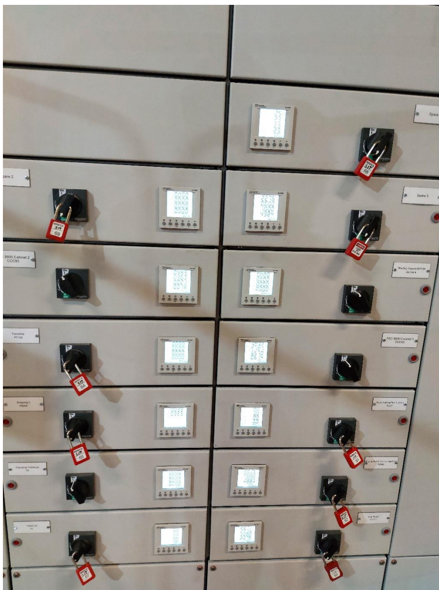
Slika 6.18 Glavni razvodni ormar
