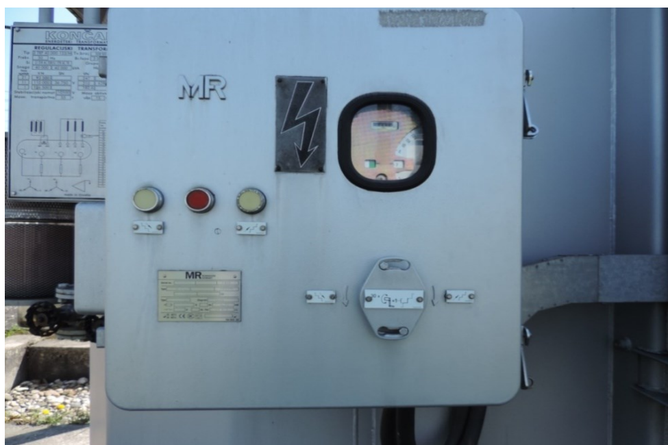
Slika 5.7 Ormar automatske regulacija transformatora "Trokut" Čakovec
