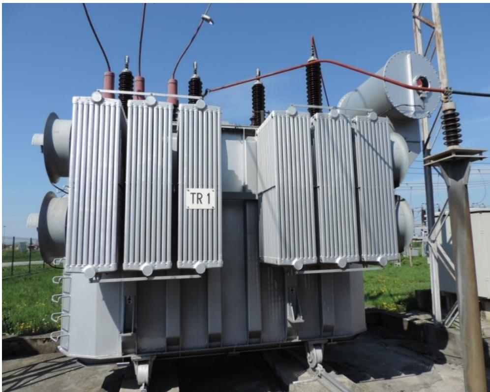
Slika 5.6 Transformator "Trokut" Čakovec
