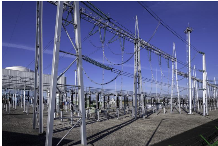
Slika 2.6 Vanjsko rasklopno postrojenje 110 kV [5]
