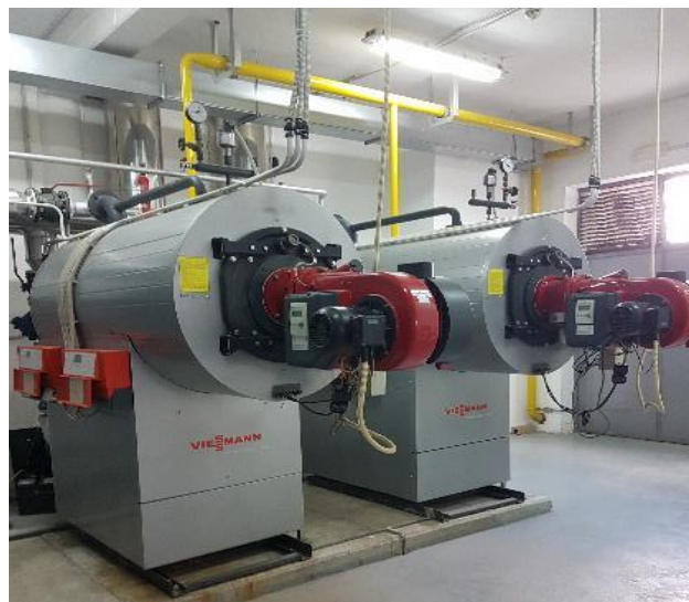
Slika 3.9 Kondenzacijski kotlovi (vlastiti izvor)
