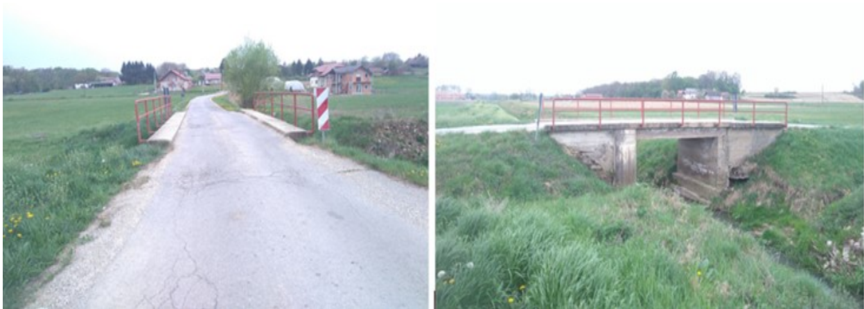
Slika 3.3. Postojeće stanje prometnice
