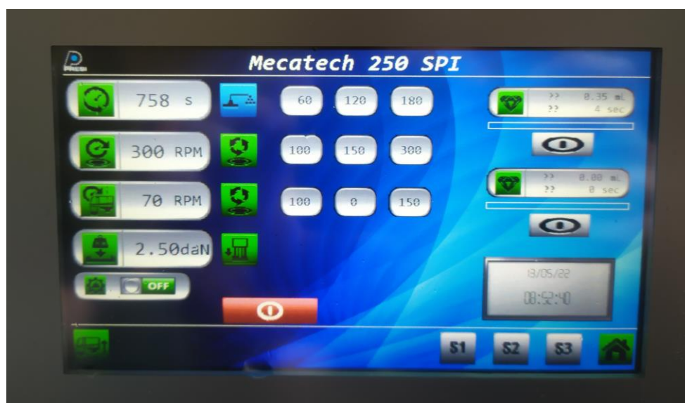
Slika 30. Sučelje upravljačke ploče stroja tijekom rada
