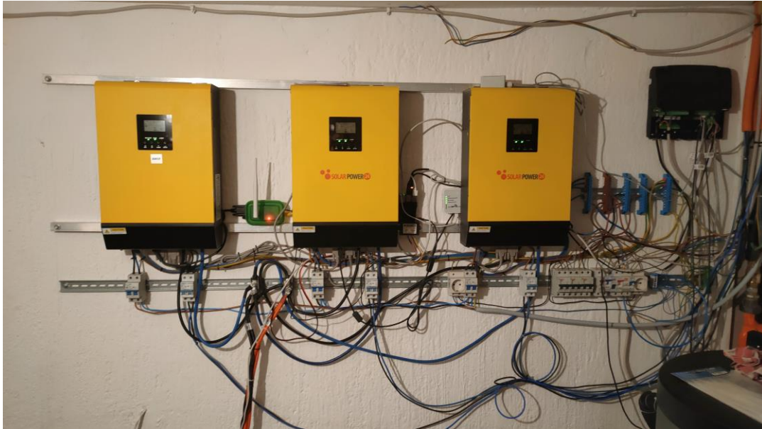
Slika 3.7 Solarni pretvarači u trofaznom sustavu
