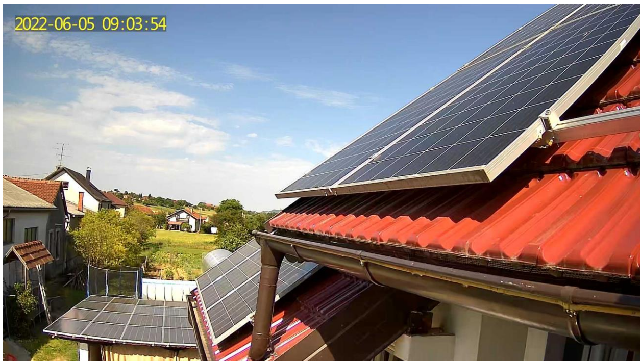
Slika 2.21 Pogled kroz solarnu WiFi kameru na solarne panele
