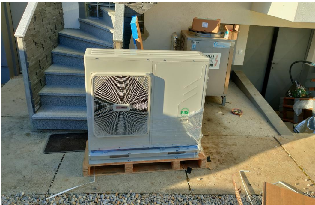
Slika 3.10 još neugrađena dizalica topline
