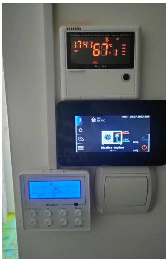
Slika 3.18 zidni uređaji za kontrolu grijanja i PTV-a
