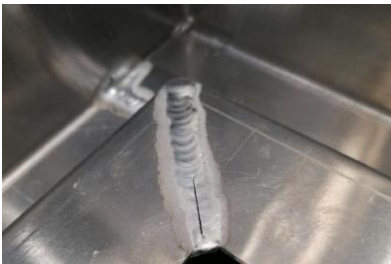
Slika 3.3. Pukotina u smjeru zavara [16]
