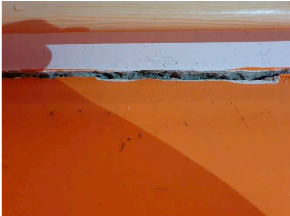
Foto 18. Horizontalna pukotina na spoju MK i vanjskog zida(J zid) - OŠTEĆENJE TIP 2 (MK – međukatna konstrukcija)
