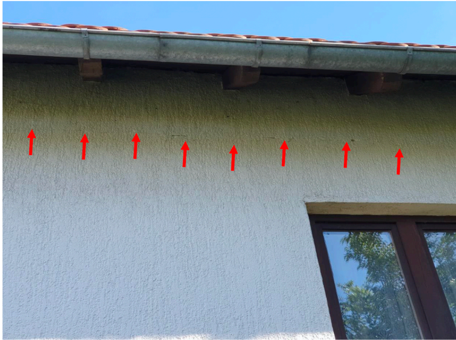
Foto 9. Pukotina u vanjskom zidu (J pročelje) – OŠTEĆENJE TIP A 2
