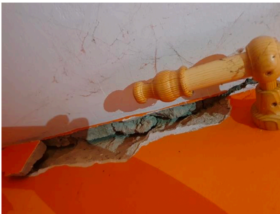
Foto 17. Horizontalna pukotina na spoju MK i vanjskog zida(J zid) - OŠTEĆENJE TIP 2 (MK – međukatna konstrukcija)
