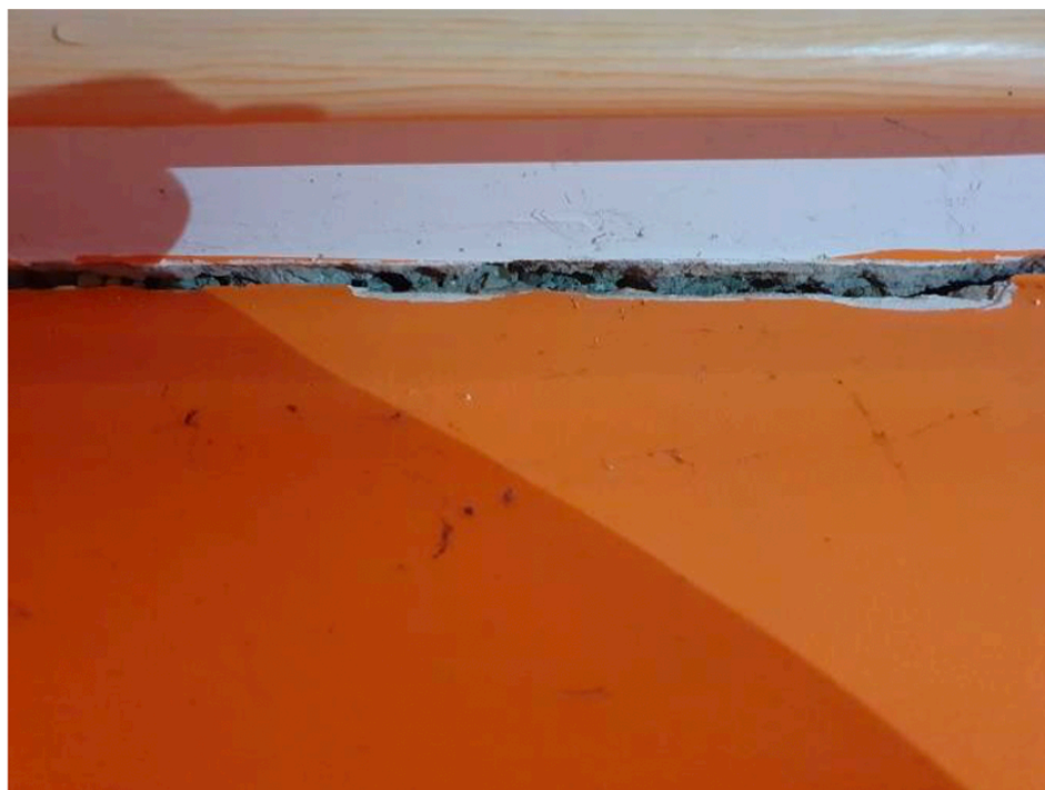
Foto 18. Horizontalna pukotina na spoju MK i vanjskog zida(J zid) - OŠTEĆENJE TIP 2 (MK – međukatna konstrukcija)
