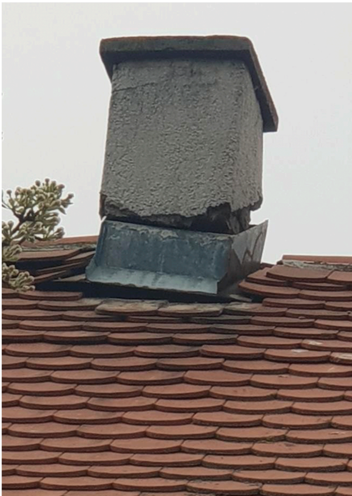
Foto 6. Oštećeni dimnjak, pokrov i limarski opšav (S pročelje) – OŠTEĆENJA TIP A 2
