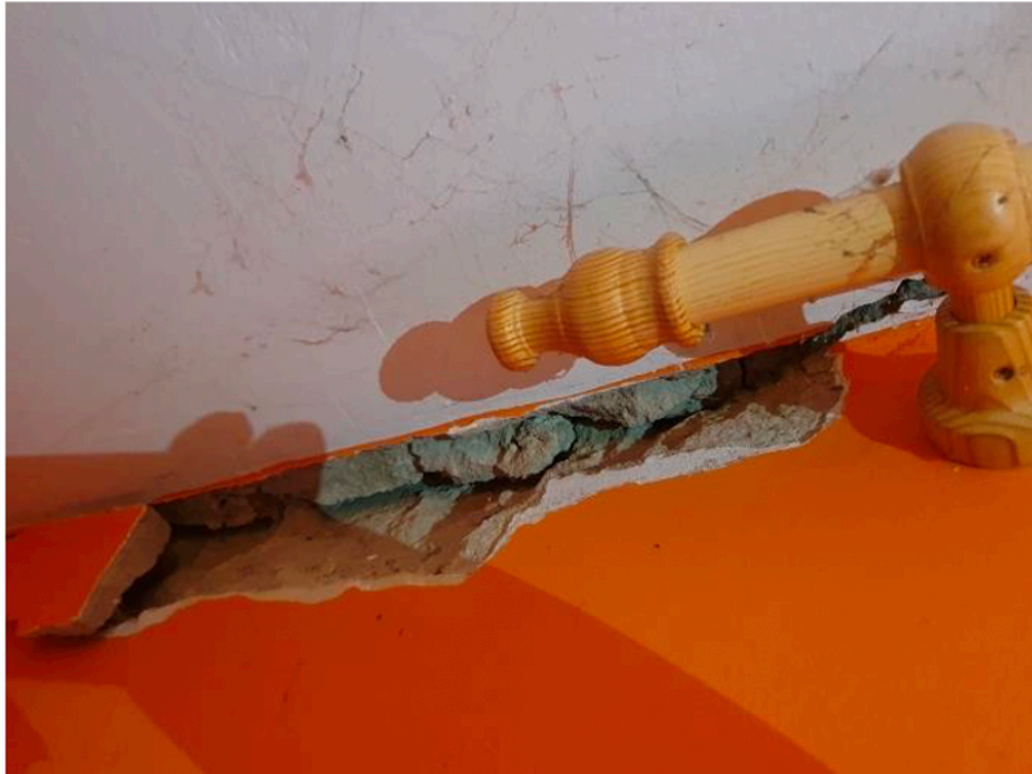
Foto 17. Horizontalna pukotina na spoju MK i vanjskog zida(J zid) - OŠTEĆENJE TIP 2 (MK – međukatna konstrukcija)
