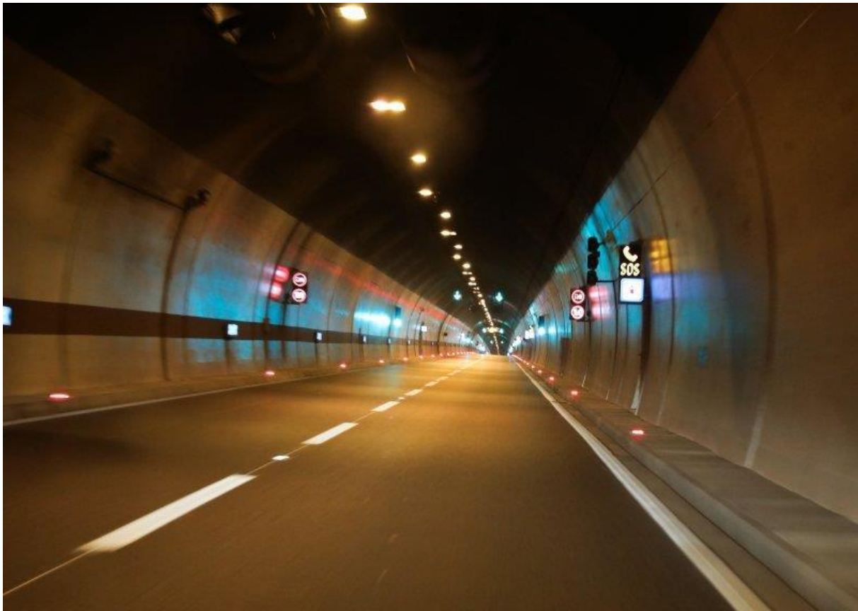
Slika 6. Rasvjetna tijela u tunelu Mravinci
