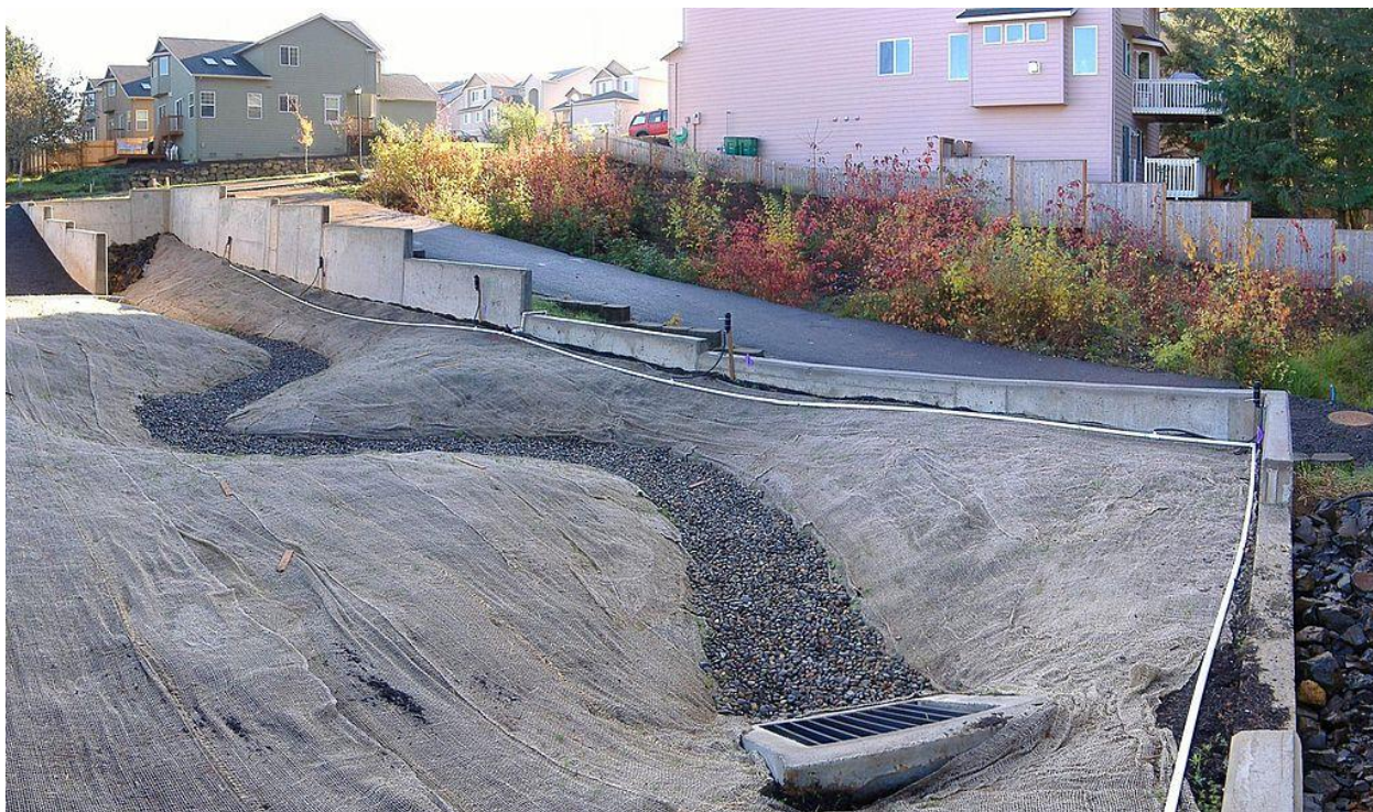
Slika 13. Kanal dizajniran da koncentrira i odvedu oborinske vode dok uklanja ostatke i onečišćenje
