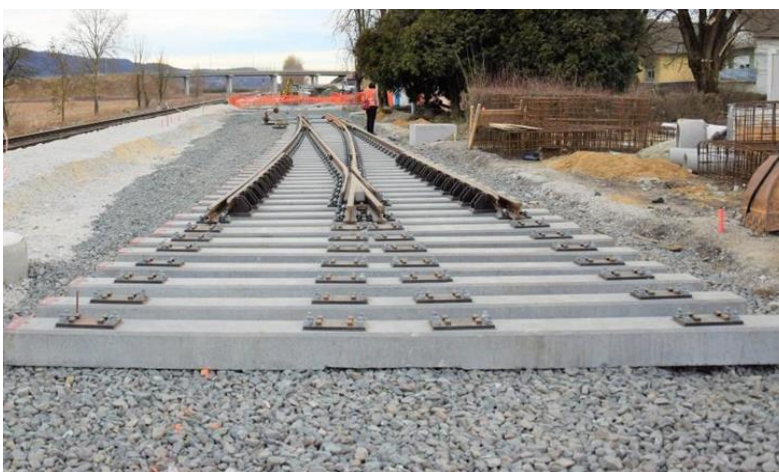
Slika 42. Željeznička skretnica na betonskim pragovima
