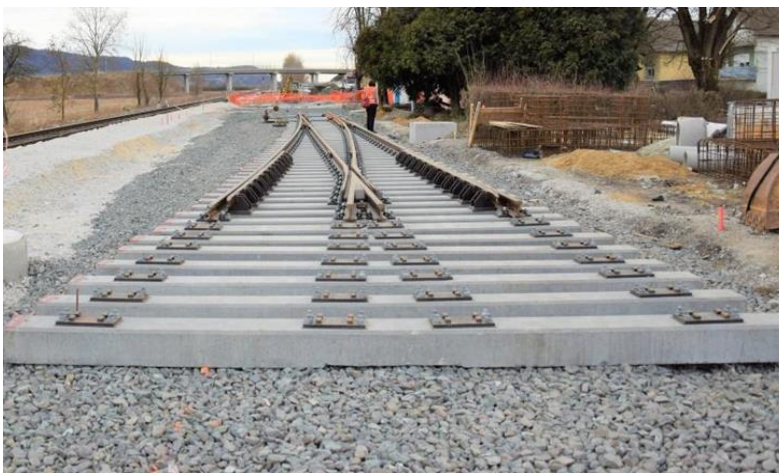
Slika 42. Željeznička skretnica na betonskim pragovima
