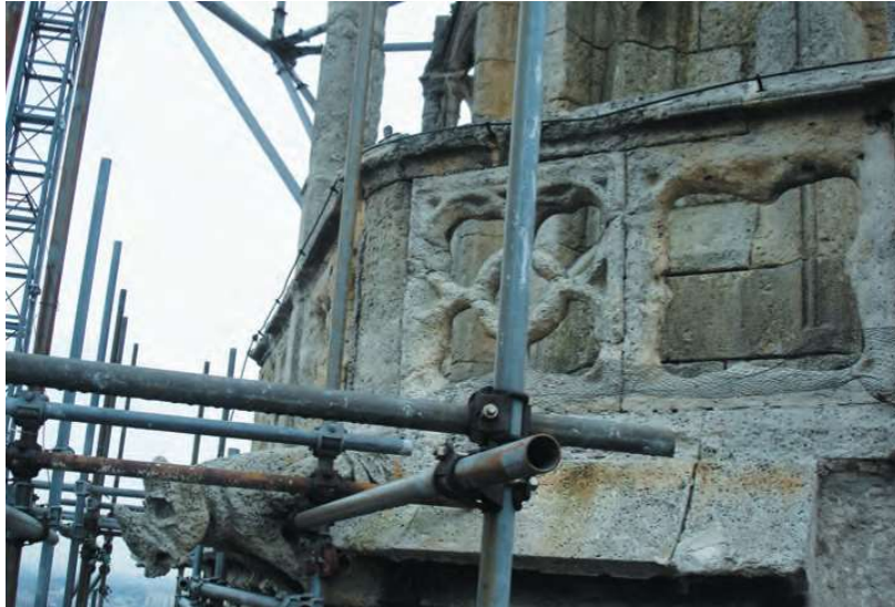
Slika 3. Oštećenje Zagrebačke katedrale nastalo zbog kiselih kiša [31]
