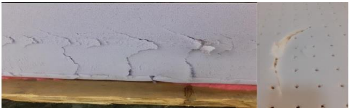
Slika 3.1.2 Primjer oštećenog materijala [8]
