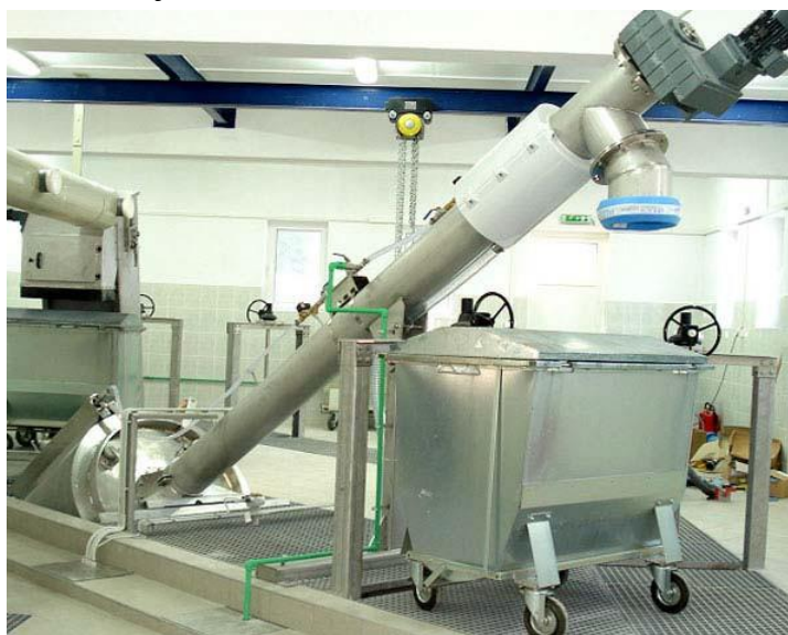
Slika 4.3. Primjer automatske fine rešetke [19]
