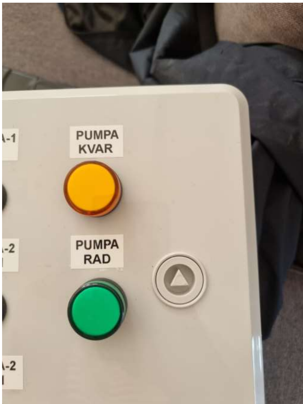
Slika 5.4. Indikatori u rashladnom sustavu
