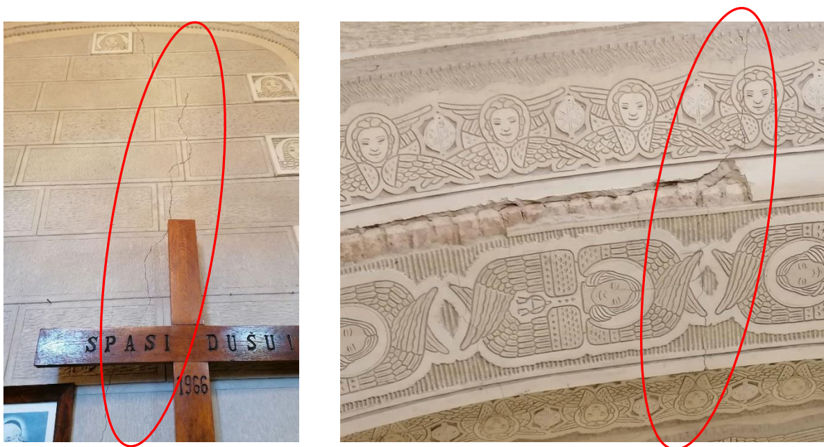
Slika 34. Vertikalna pukotina proteže se kroz cijelu visinu sjevernog zida te se širi dalje na istočno podtjemlje luka, odmah uz taj zid kapele
