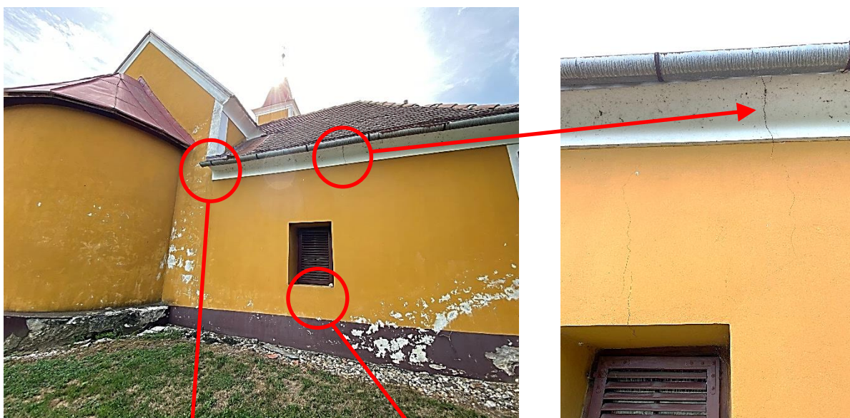
Slika 17. Desno pukotina O7
