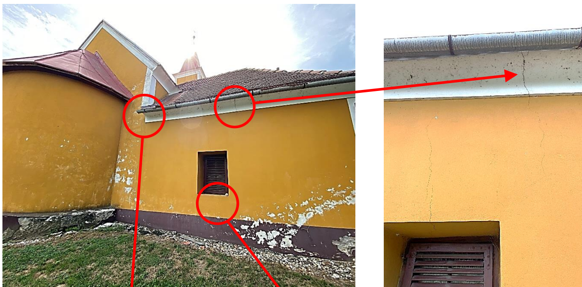
Slika 17. Desno pukotina O7
