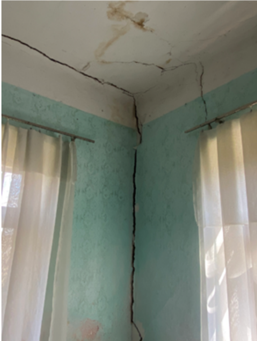
Slika 5.30. Pukotine na istočnom pročelju (desni ugao)-
