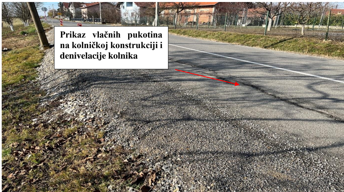
Slika 4. Prikaz zatečenog klizišta na županijskoj cesti Ž2217 Stubičke Toplice
