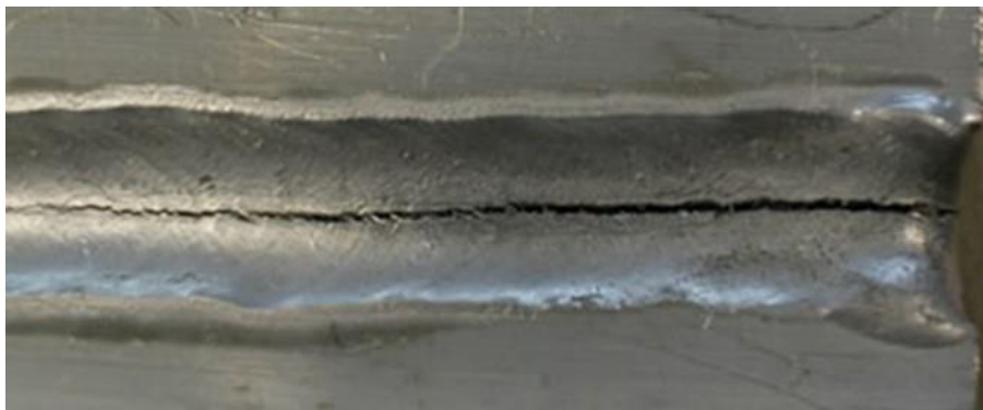
Slika 12. Pukotina u zavarenom spoju [12]
