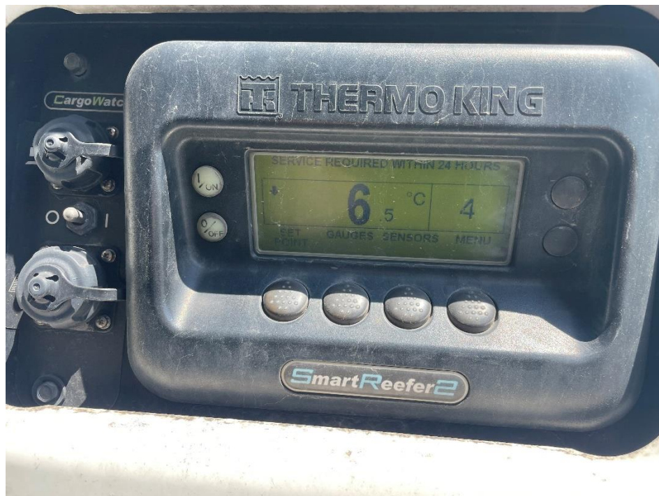
Slika 32: Upravna konzola rashladnog agregata ThermoKing (Marko-Trans Grupa d.o.o.)
