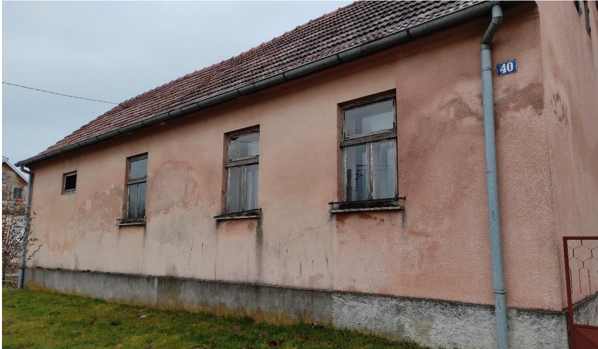
Slika 4.5 - Sjeverno pročelje - šteta od kapilarne vlage
