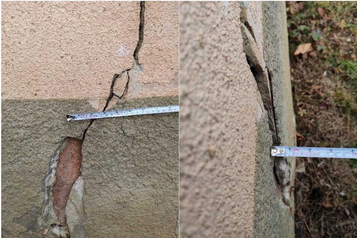
Slika 4.15 - Južno pročelje - odlamanje žbuke od zida
