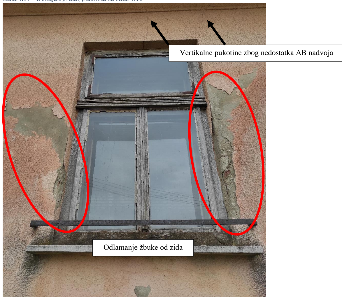
Slika 4.18 - Sjeverno pročelje – vertikalne pukotine i odlamanje žbuke od zida
