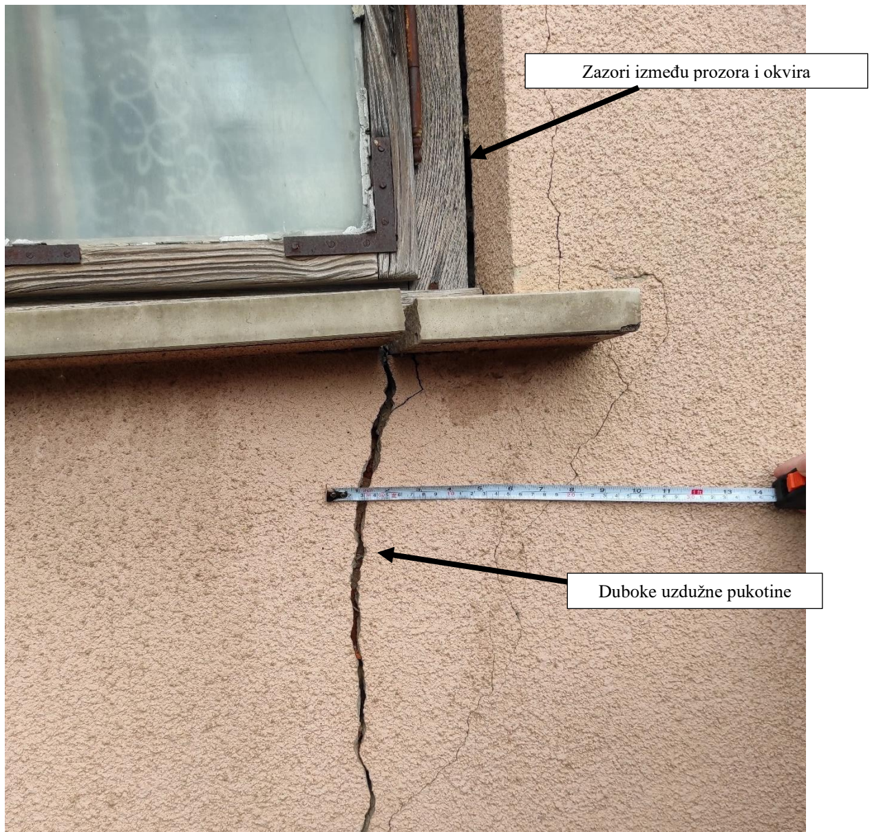
Slika 4.14 - Detaljan prikaz pukotine sa slike 4.13
