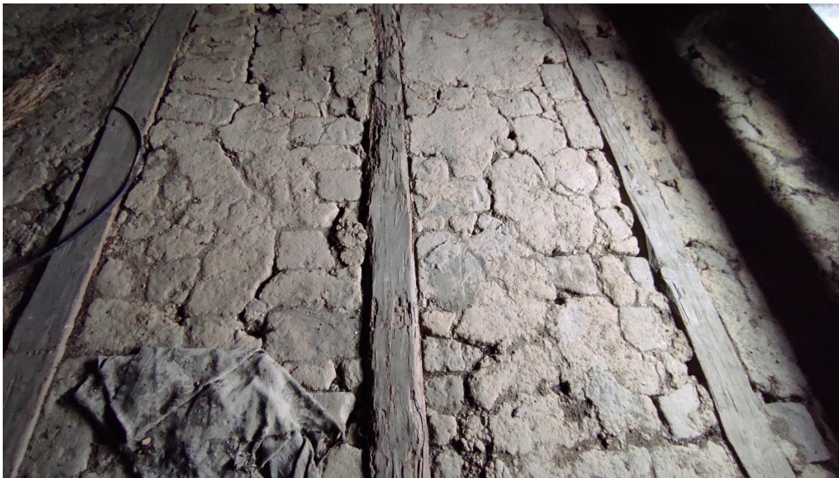
Slika 2.9 - Gornji dio stropa gdje se vidi opeka između greda
