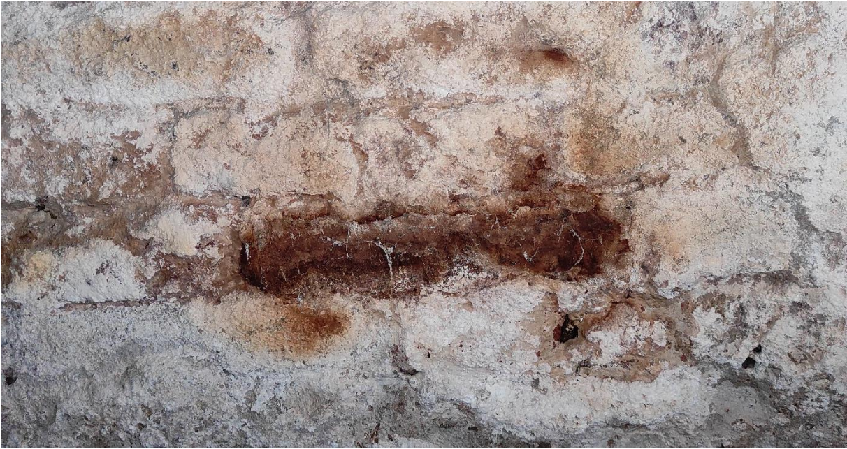
Slika 4.3 - Podrum - plijesni na površini zidova
