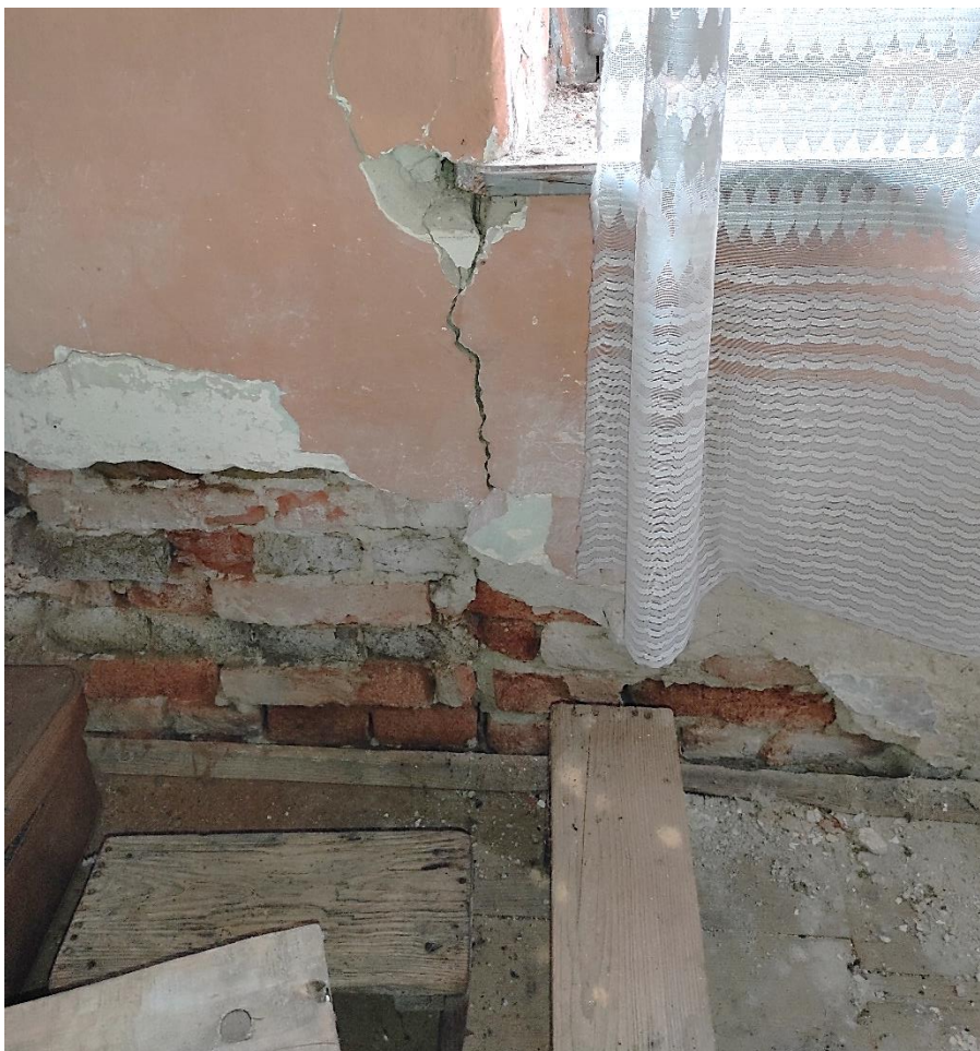
Slika 4.23 – Južno pročelje - odlamanjem većih dijelova građevnog materijala uslijed kapilarne i higroskopne vlage
