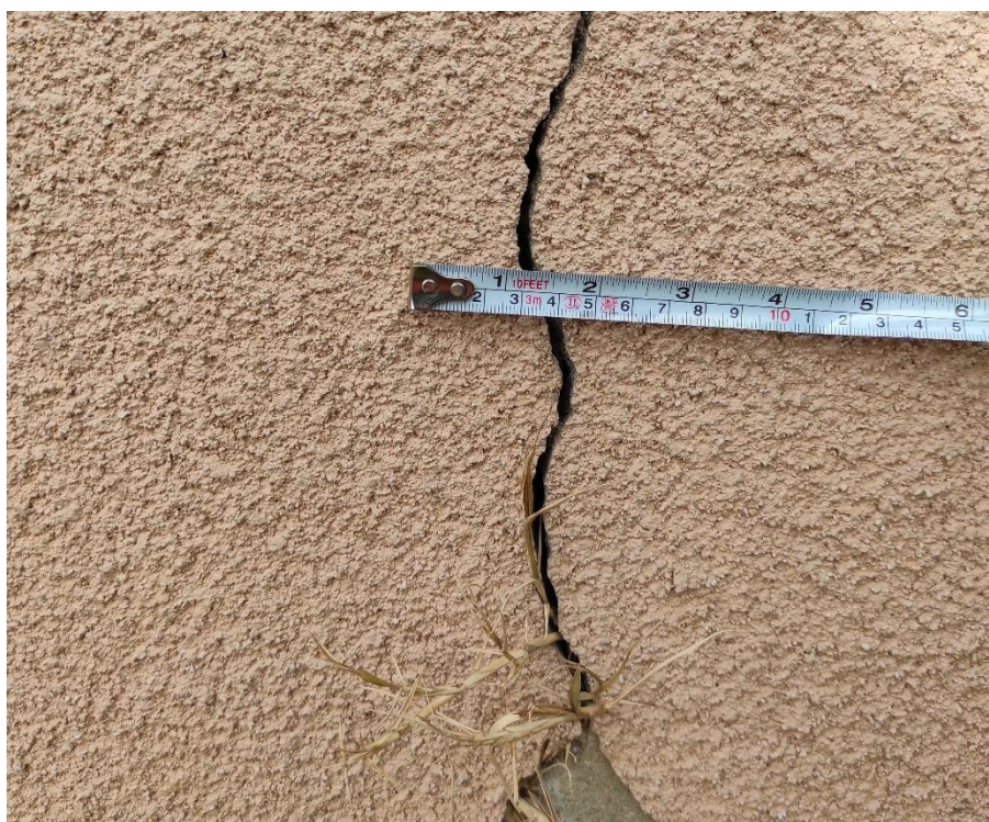
Slika 4.12 - Detaljan prikaz pukotine sa slike 4.10 lijevo od prozora
