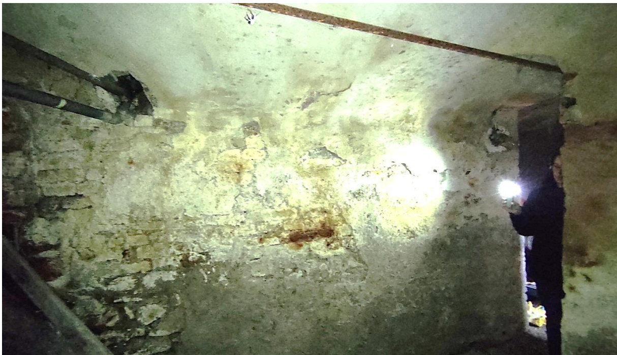
Slika 4.4 - Podrum - raslojavanje, otpadanje žbuke, plijesni na površini
