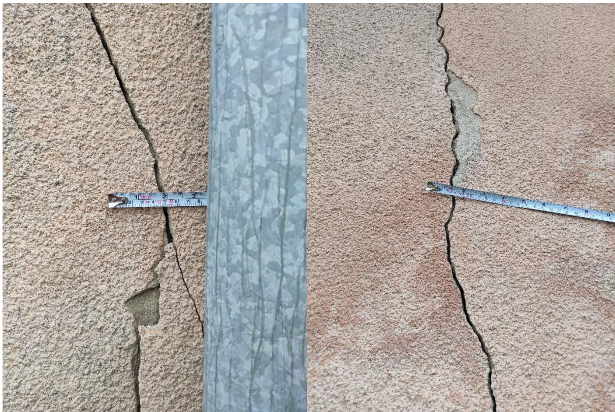
Slika 4.17 - Detaljan prikaz pukotina sa slike 4.16
