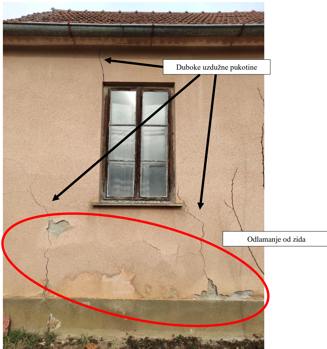
Slika 4.10 - Južno pročelje -duboke uzdužne pukotine, odlamanje od zida
