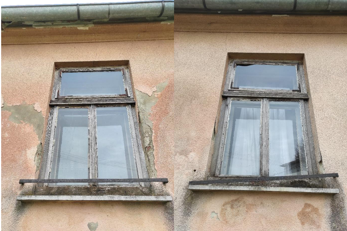
Slika 4.24 - Sjeverno pročelje sa vanjske strane – vertikalne pukotine i odlamanje žbuke od zida
