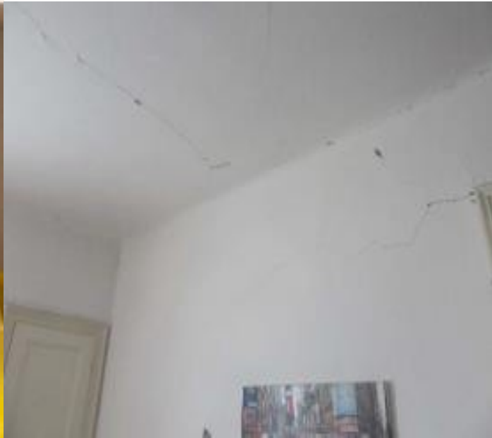
Slika 3.20. stanje pregradnih zidova 2
