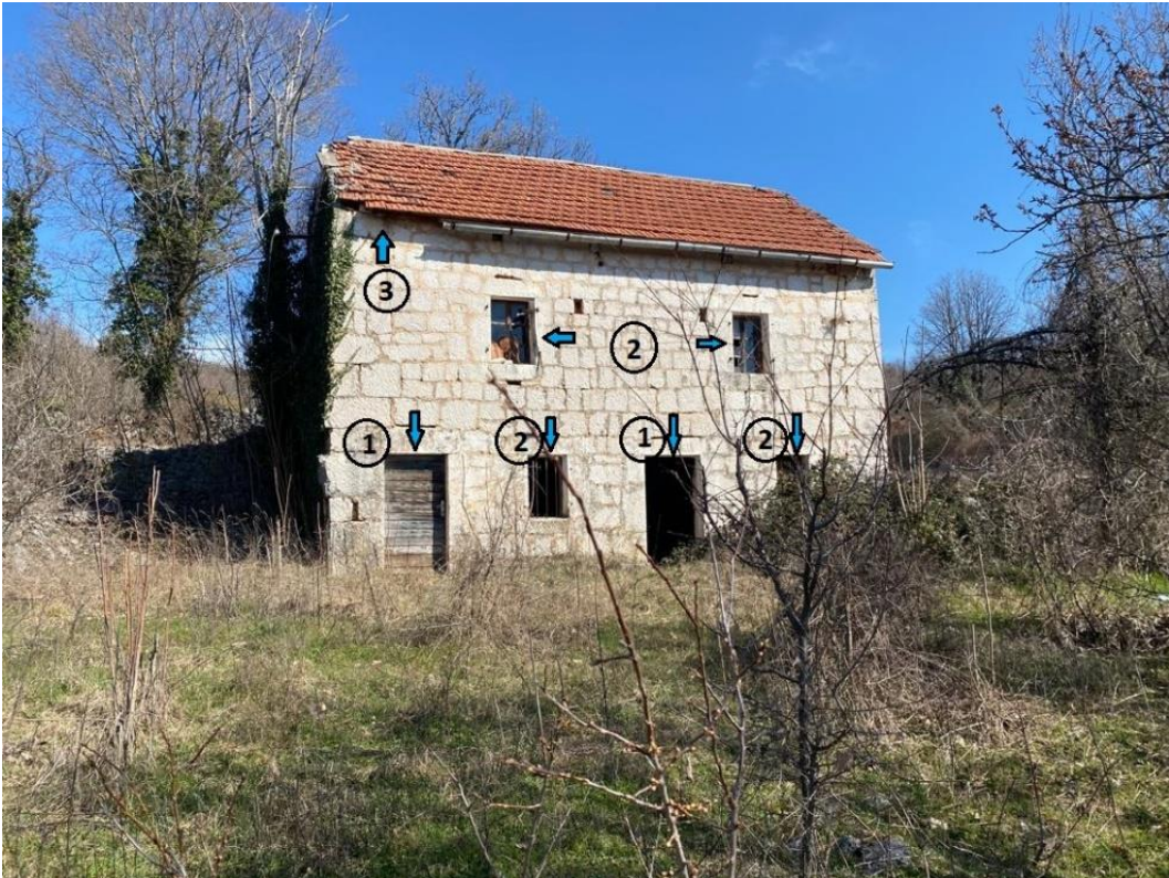
Fotografija 12: Oštećenja - jugozapad – označena sa brojevima [3]
