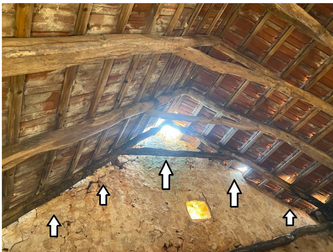
Fotografija 25: Oštećenje zabatnog zida i samog sljemena krovišta [3]
