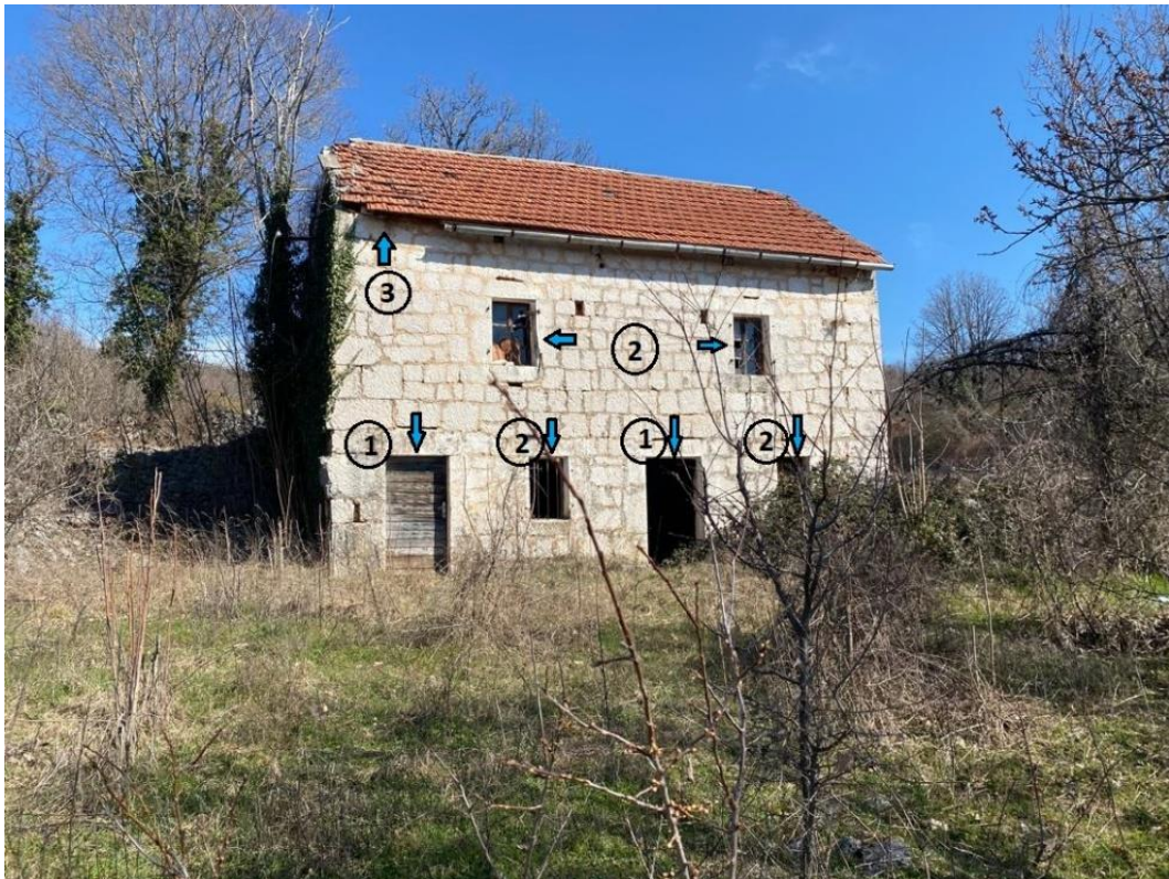
Fotografija 12: Oštećenja - jugozapad – označena sa brojevima [3]
