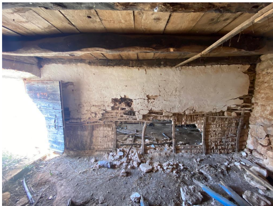
Fotografija 32: Oštećenja na pregradnom zidu [3]
