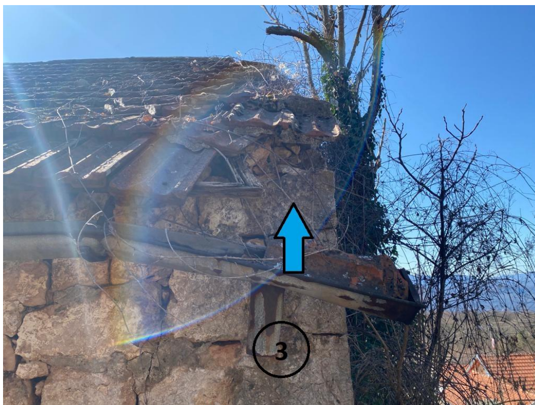
Fotografija 16: Oštećenja vanjskog zida sjeveroistočne strane - DETALJ [3]
