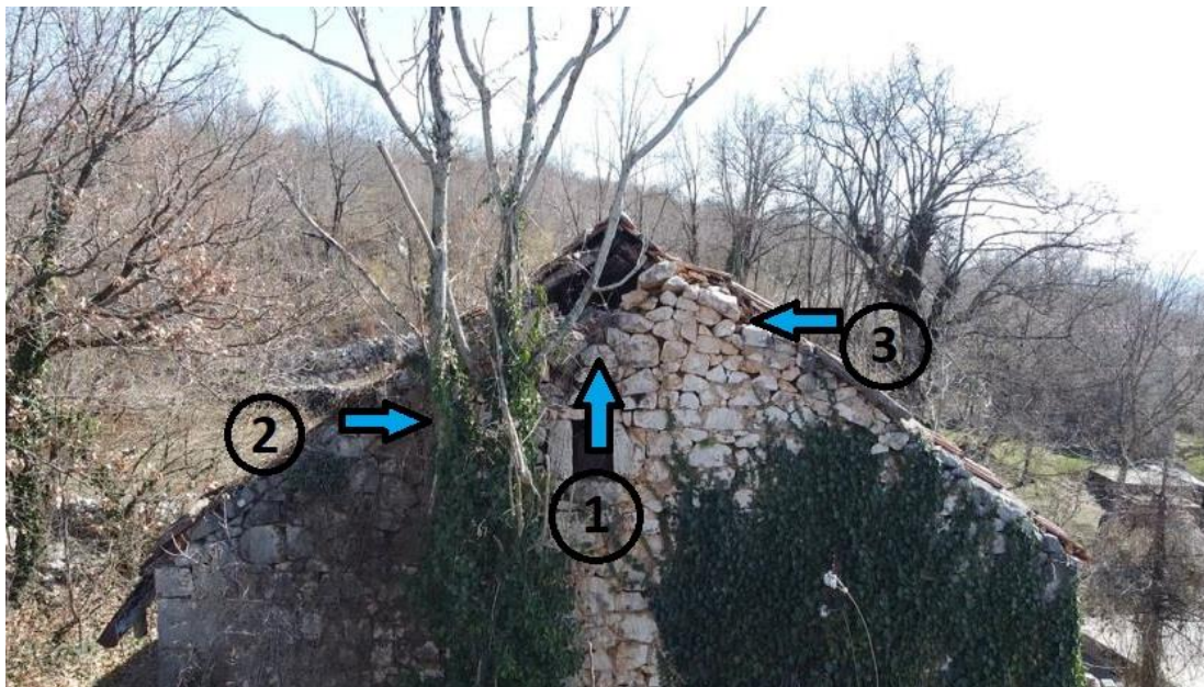
Fotografija 20: Oštećenje zabatnog zida (označeno sa br. 1), Oštećenje nastalo od divljeg bilja (označeno sa br. 2), Urušavanje zabatnog zida (označeno sa br. 3) [3]
