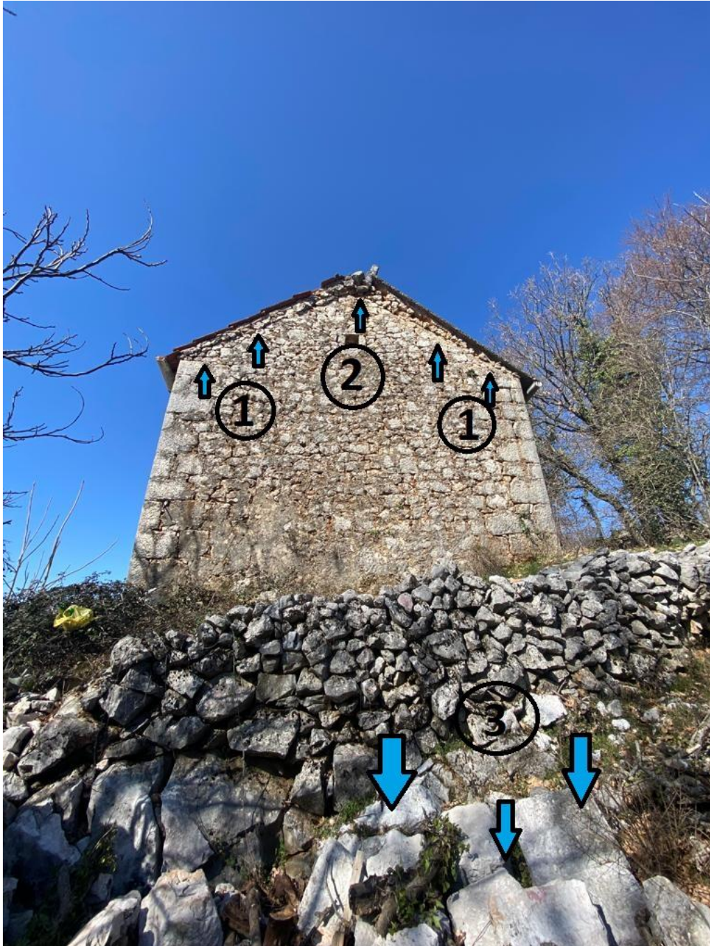
Fotografija 21: Oštećenje zabatnog zida (označeno sa br. 1), Oštećenje – urušavanje dimnjaka (označeno sa br. 2), Ostaci kamena sa dimnjaka (označeno sa br. 3) [3]
