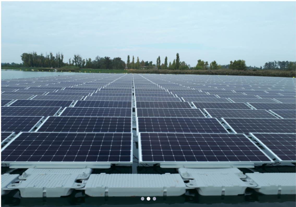
Slika 35 Solarni paneli na plutajućoj platformi elektrane OMEGA1 [25]
