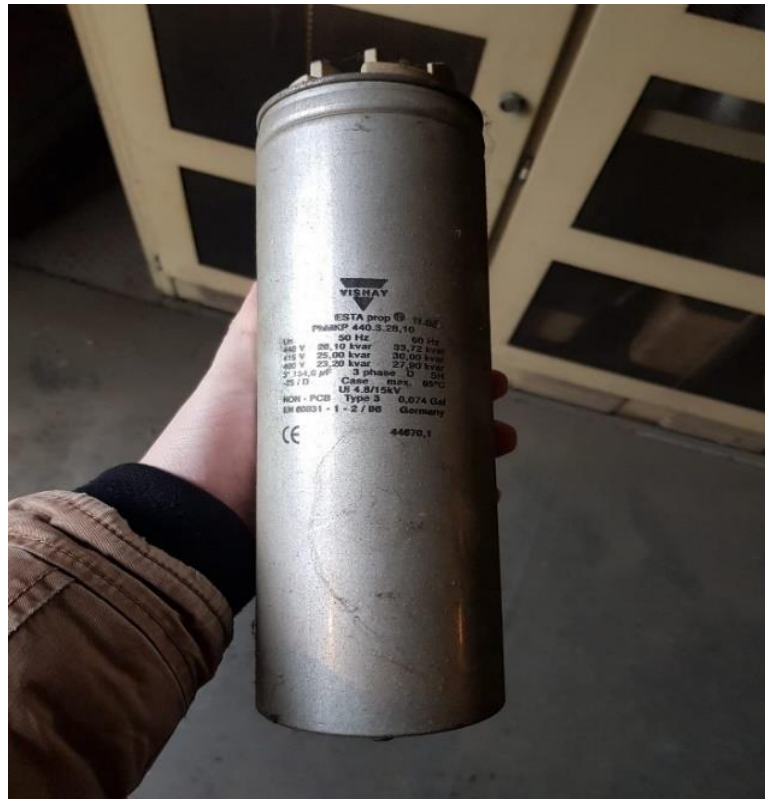
Slika 22. Trofazna kondenzatorska baterija
