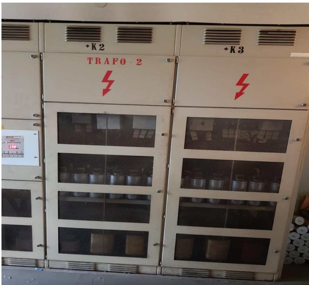
Slika 16. Kompenzacijski ormar u transformatorskoj stanici TS1
