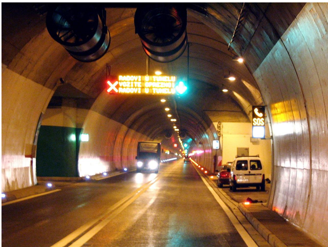
Slika 33. Prometna i ostala oprema u tunelu-oznake evakuacijskih puteva, ventilatori, razglas, senzori vidljivosti..
