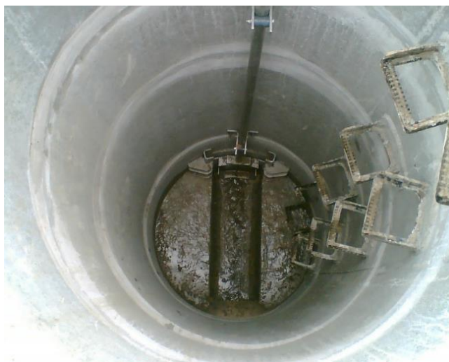
Slika 16. Primjer revizijskog okna [22]
