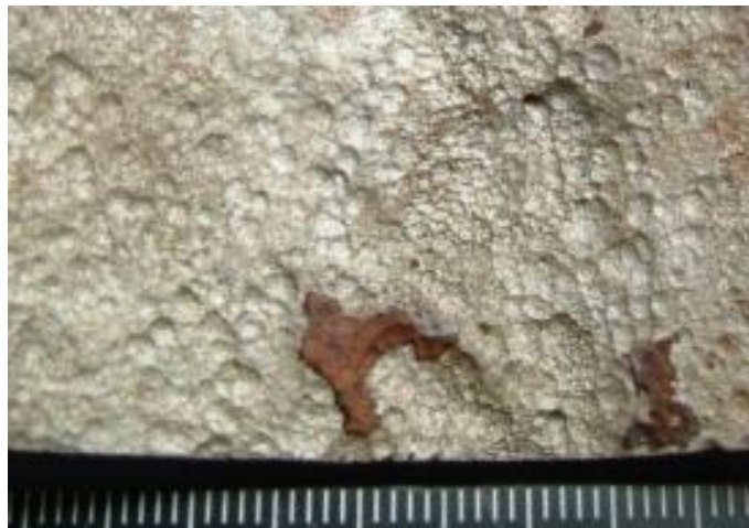
Slika 8 Neravnomjerna opća korozija [10]
