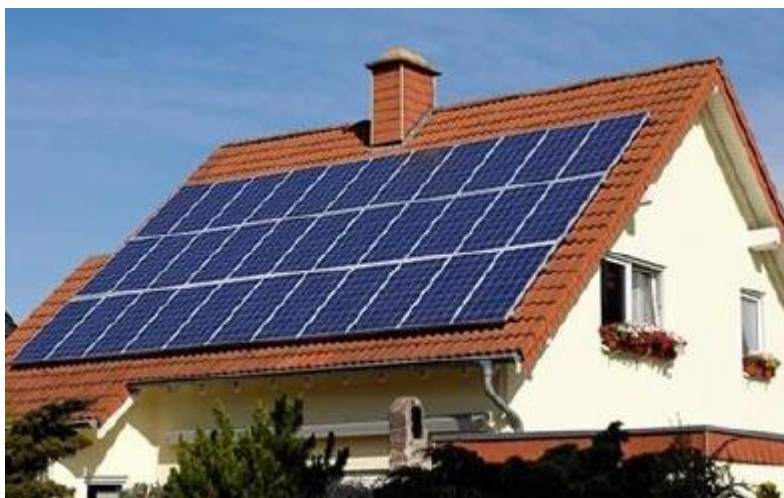
Slika 38 Primjer solarne elektrane na kosom krovu
