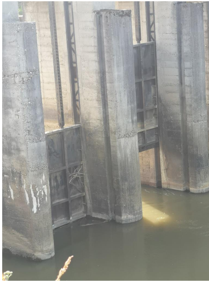
Slika 4.3. Zapornice na brani u Kućanu Ludbreškom [12]
