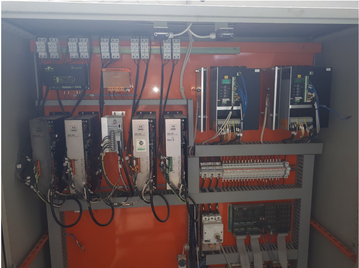
Slika 9.5 Električni ormar CNC stroja.
