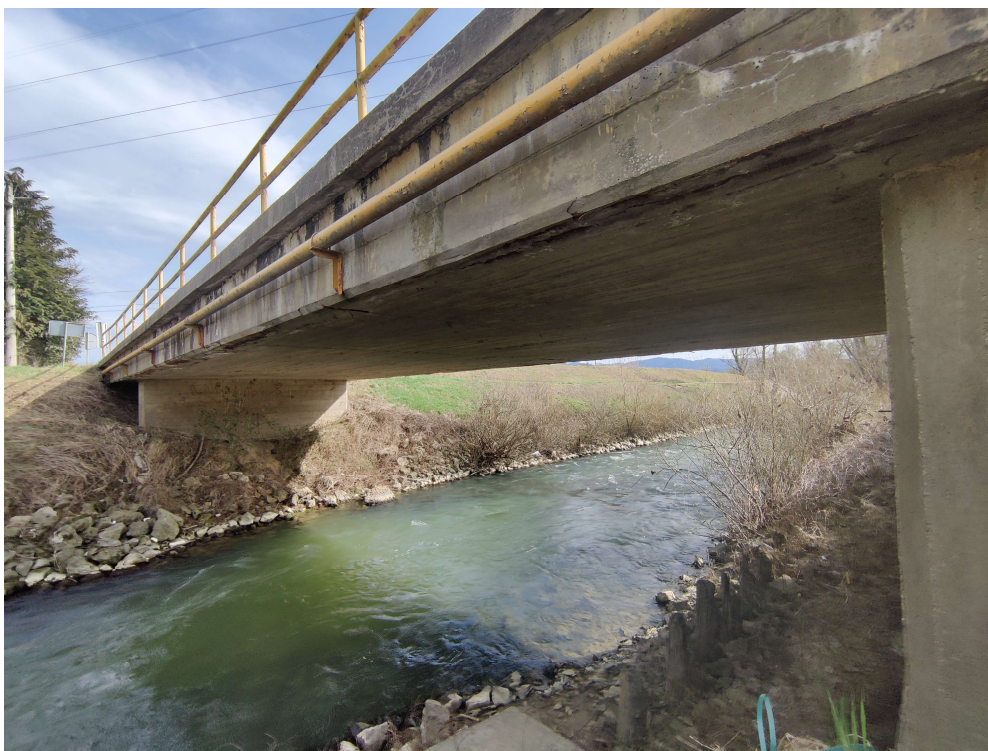
Slika 25: Oštećenje betonske konstrukcije s uzvodne strane (autorski rad)
