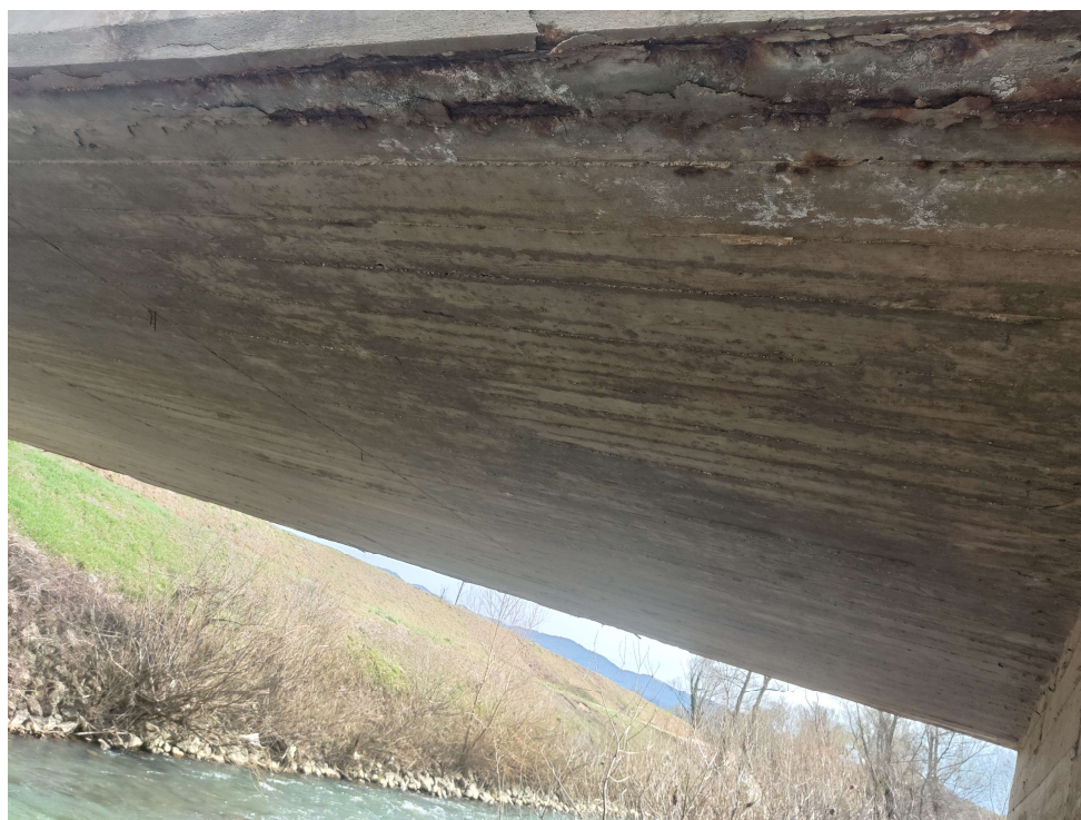
Slika 26: Ljuštenje betona s donje strane ploče (autorski rad)
