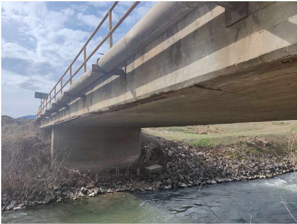
Slika 23: Oštećenje betonske konstrukcije nizvodne strane (autorski rad)
