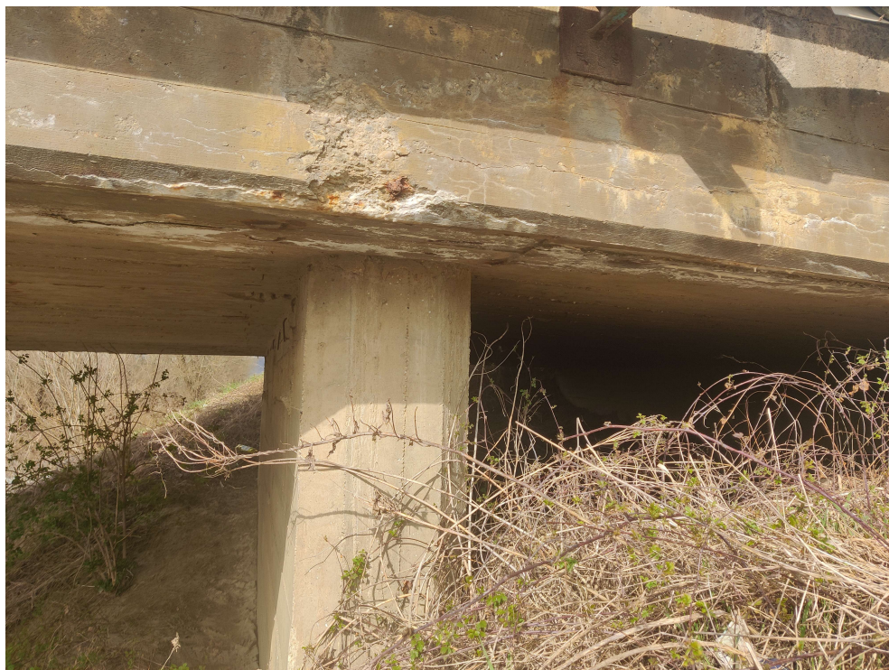
Slika 24: Oštećenje betonske konstrukcije kod oslonca (autorski rad)
