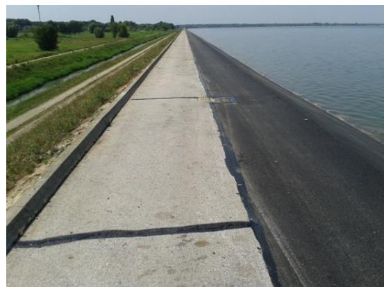
Slika 83. Detalj završenih radova na zamjeni nosivo-habajućeg asfaltnog sloja na kruni nasipa š=1,6 m
