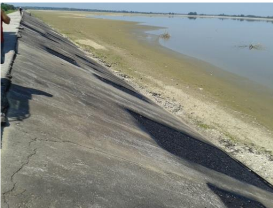
Slika 32. Uređena i bit. emulzijom prešpricana podloga plošnih oštećenja
