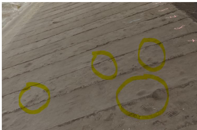
Slika 13. Oštećenja na površini mastiksa
