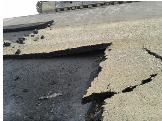
Slika 25. Loša povezanost postojećih asfaltnih slojeva
