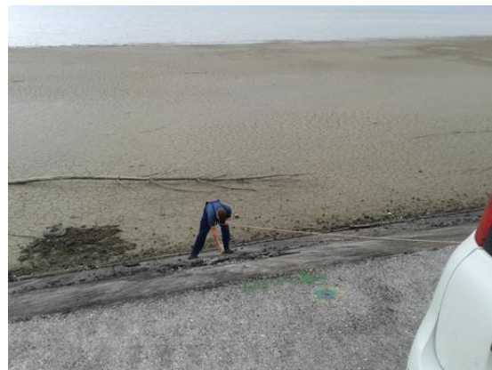
Slika 29. Označavanje granica plošnih oštećenja nosivog asfaltnog sloja
