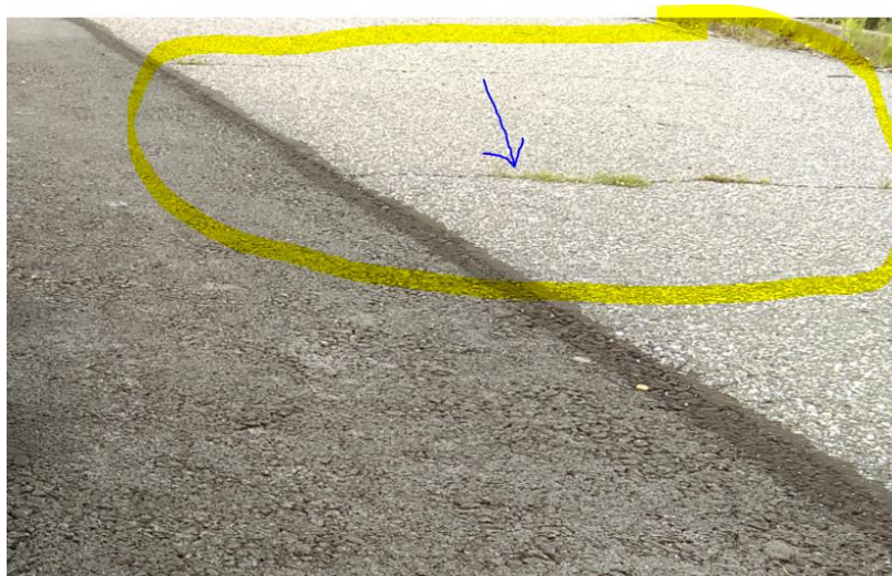
Slika 14. Oštećenja na kruni nasipa
