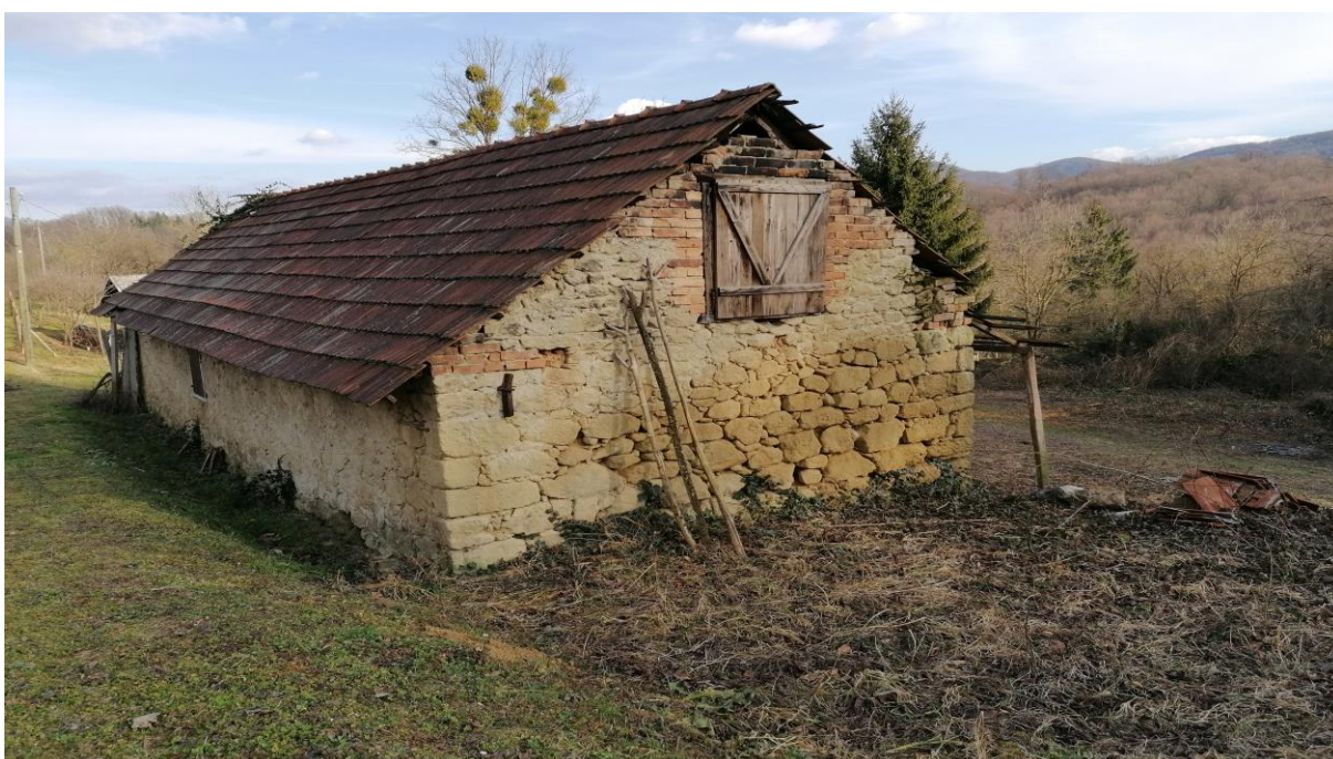
Slika 3.9: Zatečeno stanje – sjeverozapadno pročelje nakon čišćenja raslinja
