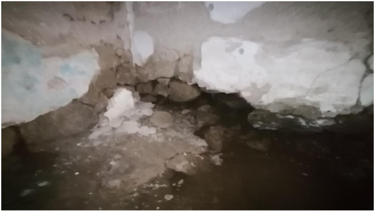
Slika 3.15: Stanje unutrašnjih zidova – prostorija 1
