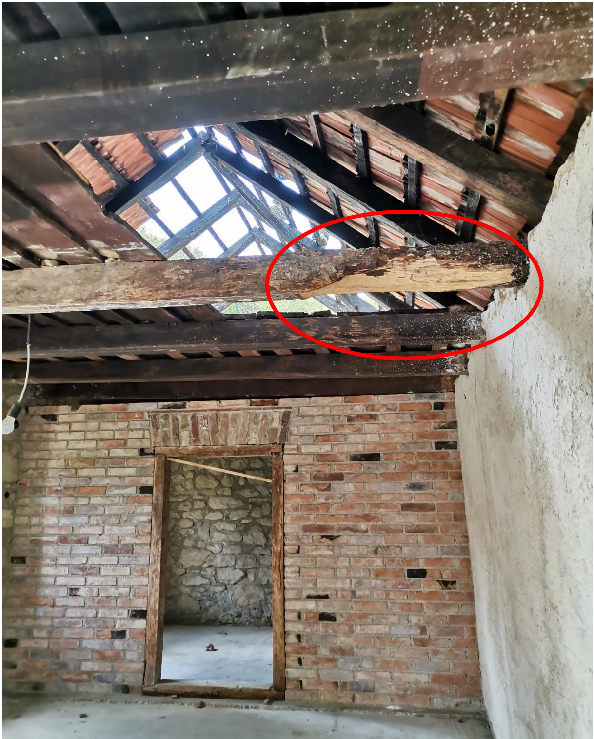
Slika 3.26: Prikaz istrunule grede nakon rušenja pregradnog zida ispod
