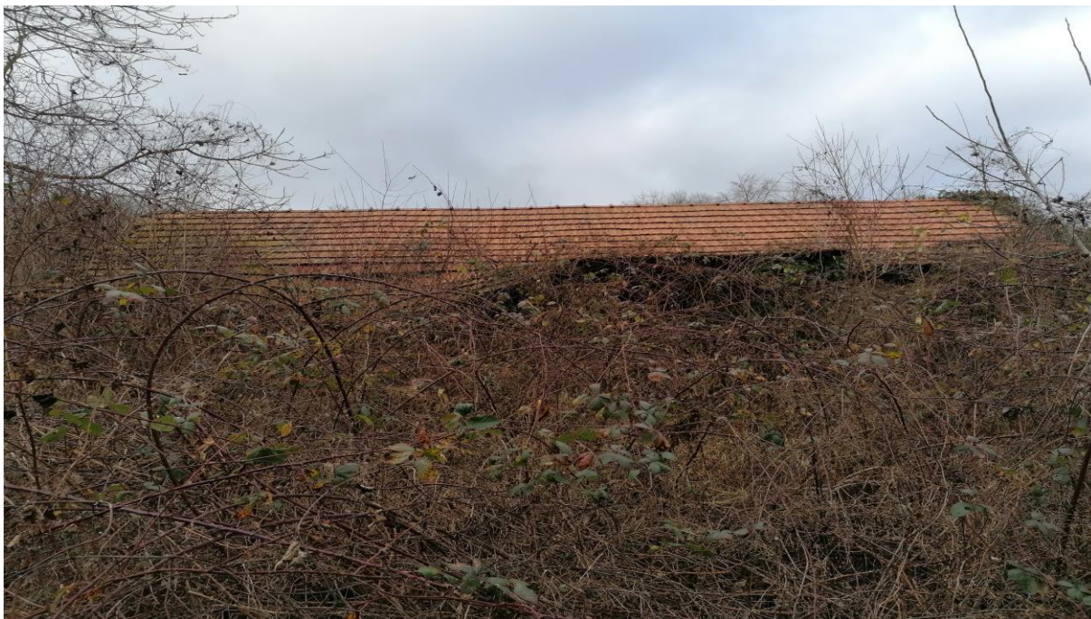
Slika 3.4: Zatečeno stanje – jugoistočno pročelje (bliži kadar)
