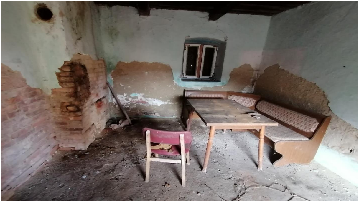
Slika 3.18: Stanje unutrašnjih zidova – prostorija 2
