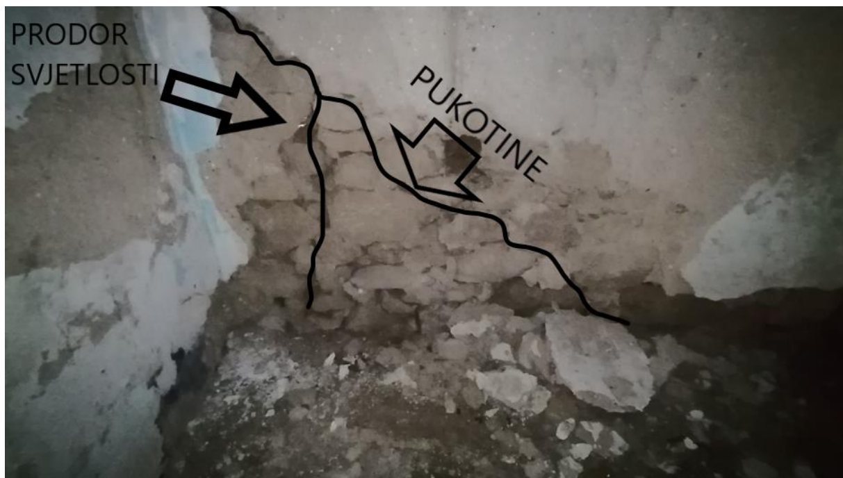
Slika 5.15: Prikaz oštećenja X1
