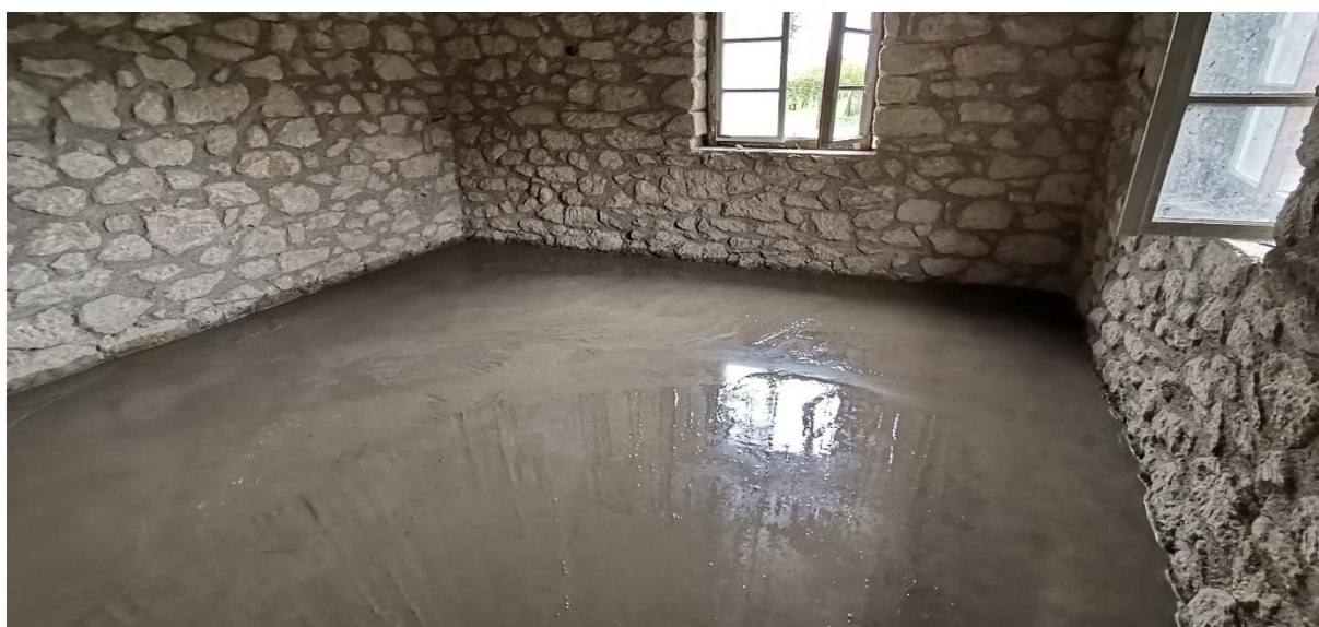
Slika 5.54: Razastiranje i zbijanje drenažnog sloja (gore), postavljanje PVC folije i armaturne (sredina) mreže, betoniranje ploče (dolje)
