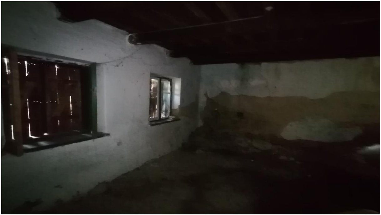
Slika 3.17: Stanje unutrašnjih zidova – prostorija 1
