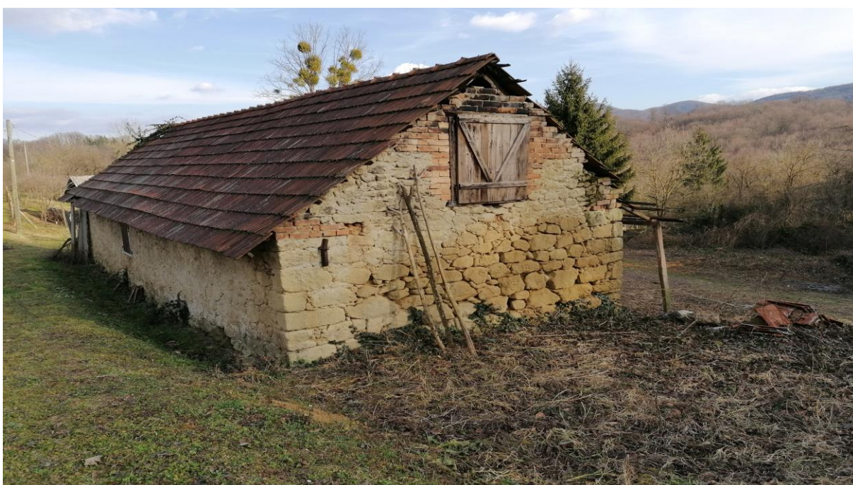
Slika 3.9: Zatečeno stanje – sjeverozapadno pročelje nakon čišćenja raslinja
