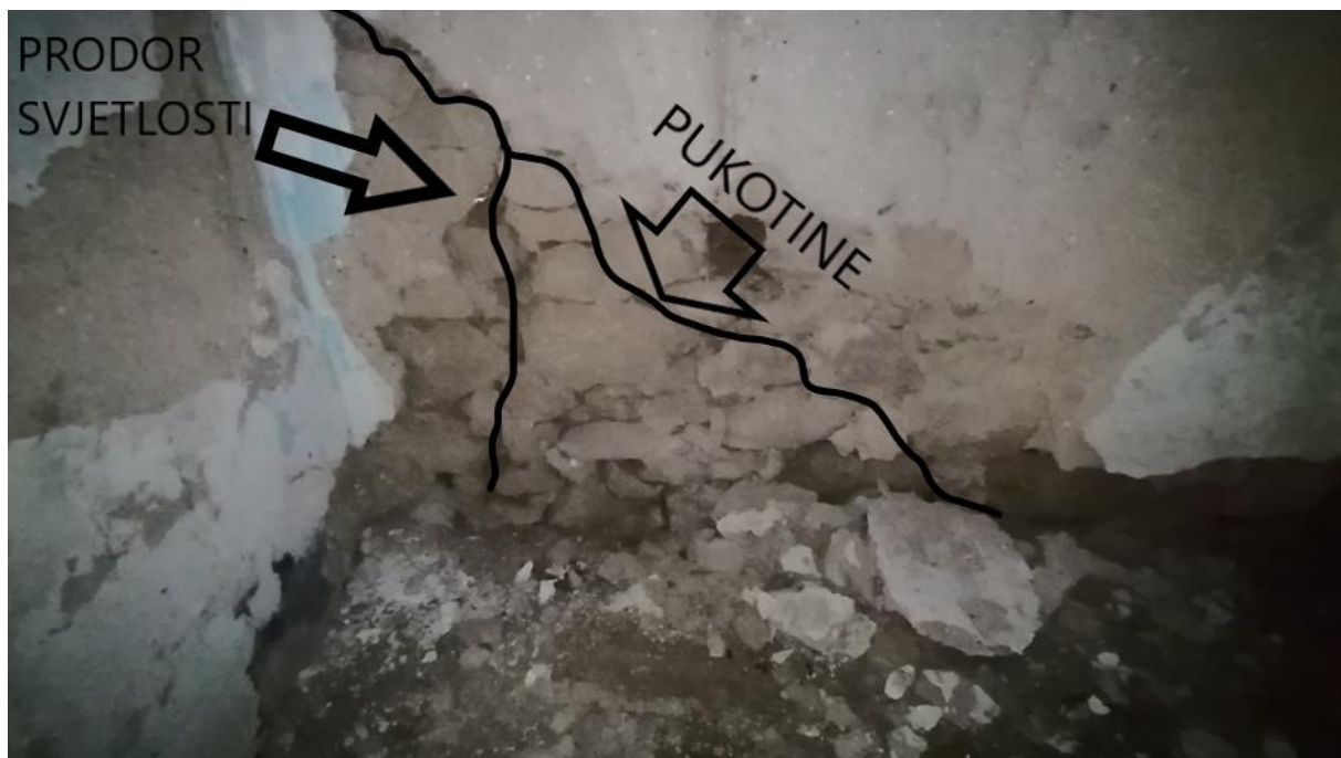
Slika 5.15: Prikaz oštećenja X1
