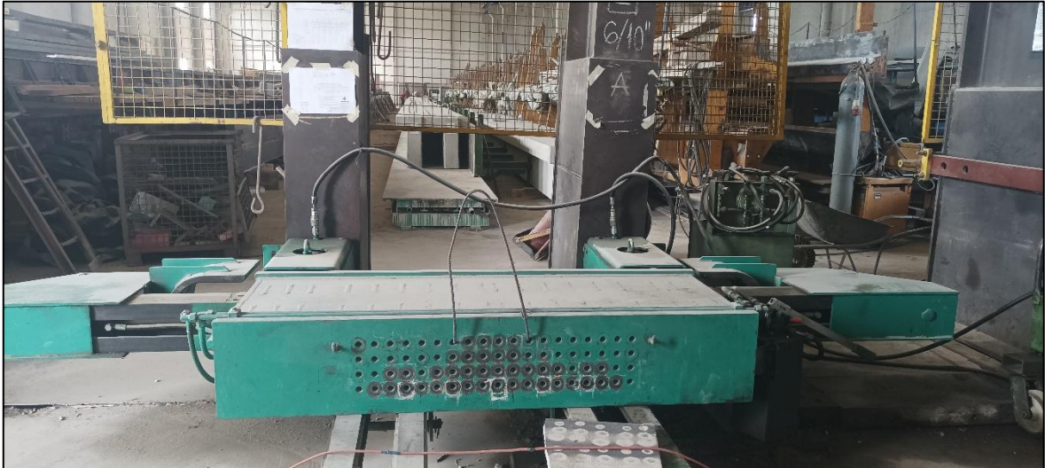
Slika 23: Unutašnjost pogona Beton Lučko d.o.o. (izvor: osobna arhiva)
