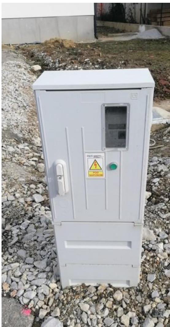
Slika 7. KPMO (kućni priključni mjerni ormar)
