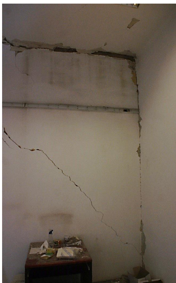
Slika 5.10 Prostorija 2. Dijagonalna pukotina zida
