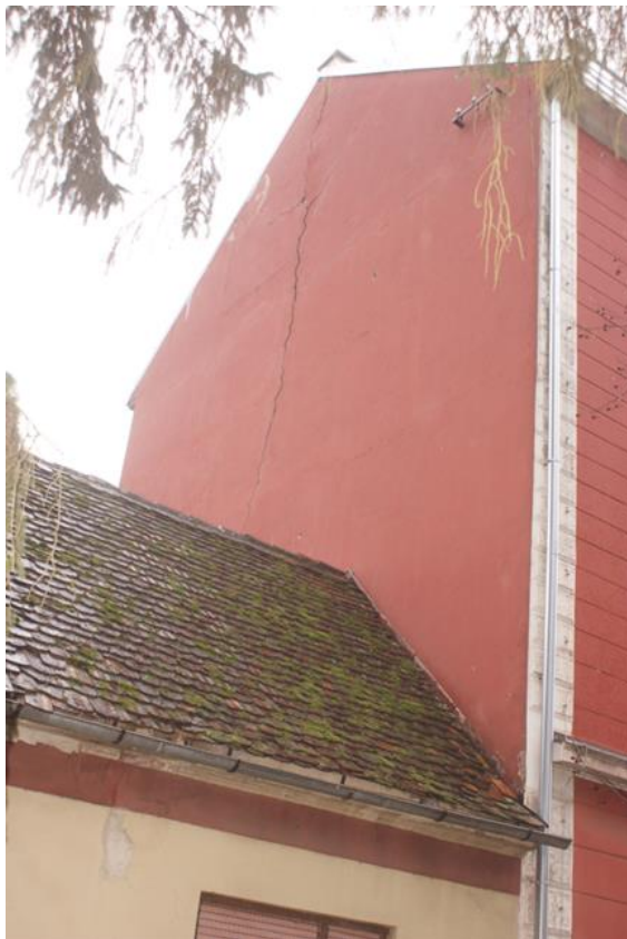
Slika 5.22 Dugačka dijagonalna pukotina
