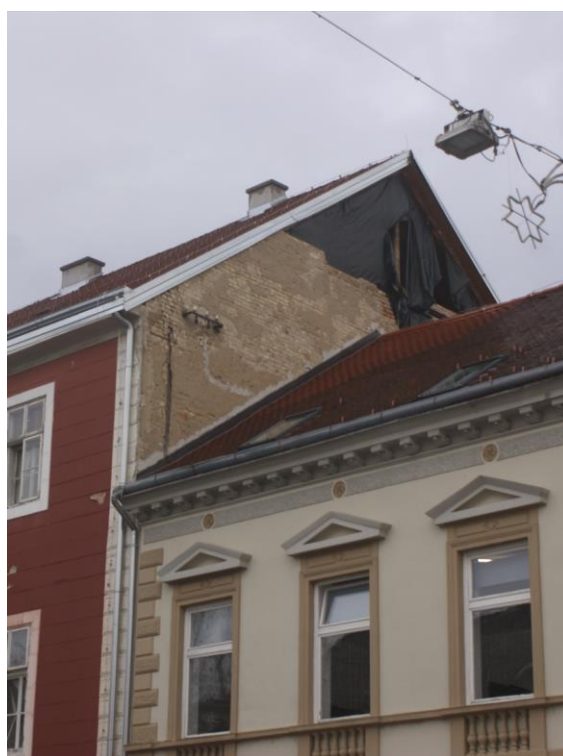
Slika 5.23 Urušeni dio zabatnoga zida
