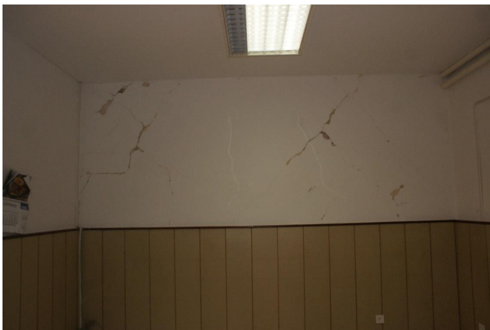
Slika 5.8 Prostorija 26. Pukotina na pregradnim zidovima
