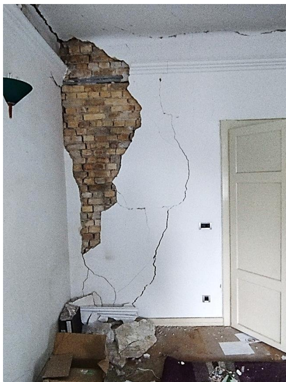
Slika 5.18 Prostorija 5.2. Dijagonalne i vertikalne pukotine na nosivom zidu
