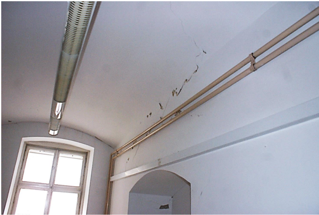
Slika 5.5 Prostorija 16. Kose pukotine u nadvoju
