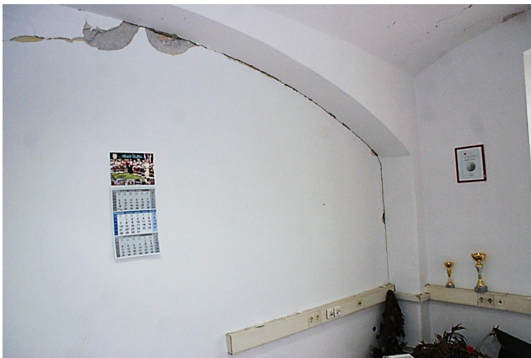
Slika 5.6 Prostorija 19. Pukotina na spoju pregradnog zida i luka
