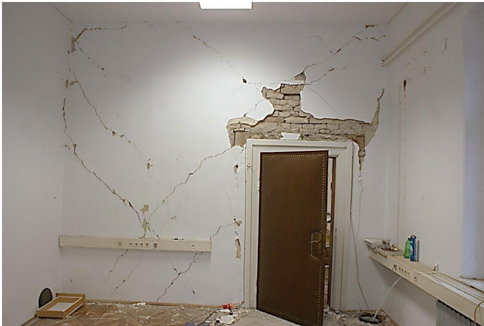
Slika 5.14 Prostorija 25. Rasprostranjene dijagonalne pukotine zida
