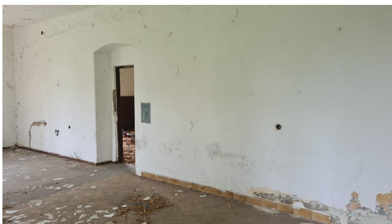
Slika 23. Prikaz oštećenja zidova testne građevine uzrokovane vlagom
