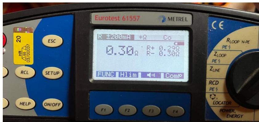
Slika 5.2. Prikaz rezultata ispitivanja kontinuiteta zaštitnog vodiča i vodiča za izjednačavanje potencijala
