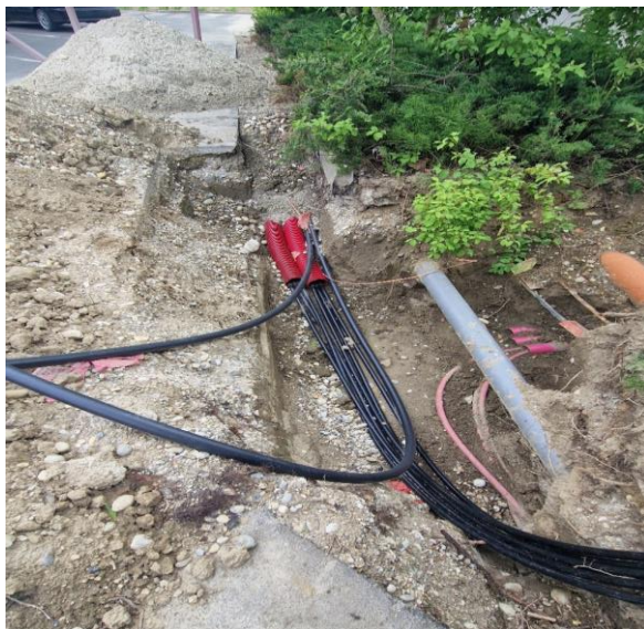
Slika 22. SN kableski vod prije spajanja
