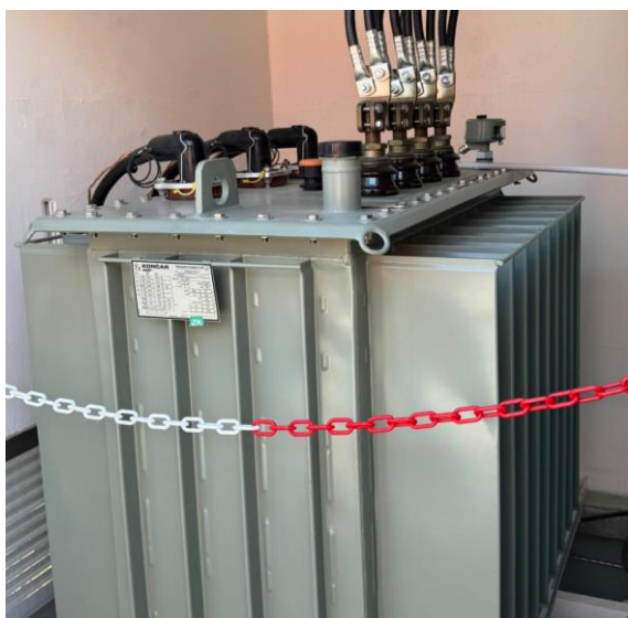
Slika 13. Trofazni uljni transformator
