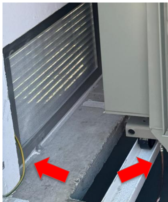
Slika 18. Zaštitno uzemljenje na vent. otvoru
