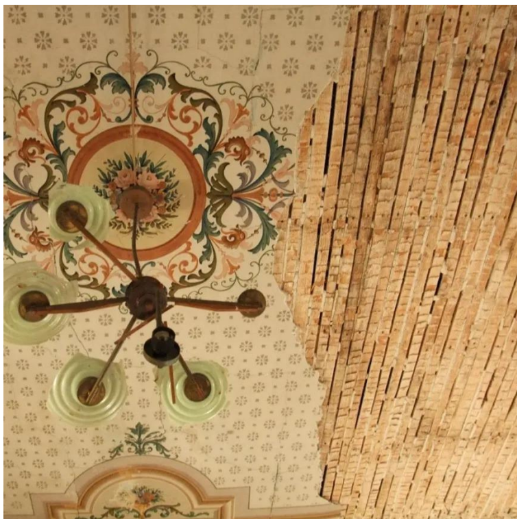
Slika 20. Oštećenje stropnih freski
