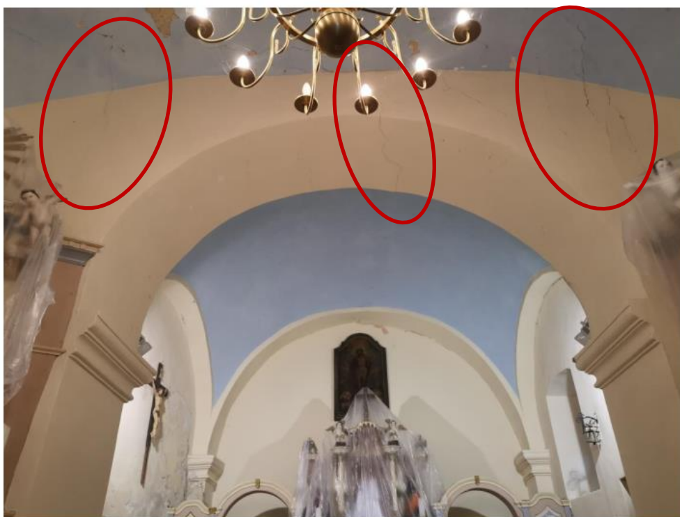
Slika 37: Pukotine na središnjem luku
