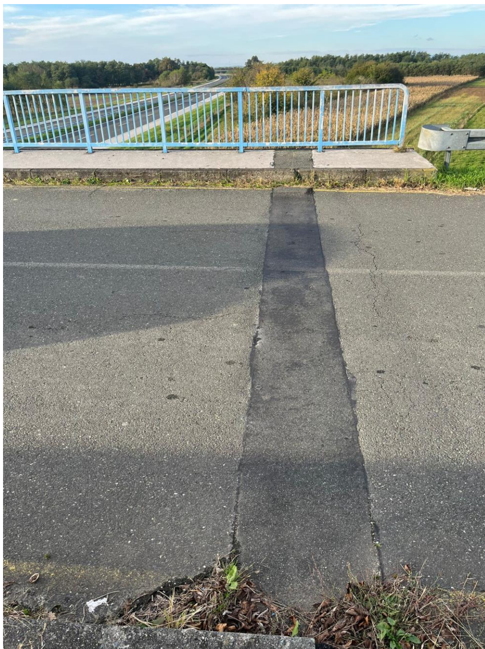
Slika 37 Bitumenska kontinuirana prijelazna naprava na nadvožnjaku u Držimurcu, (10.10.2024.)
